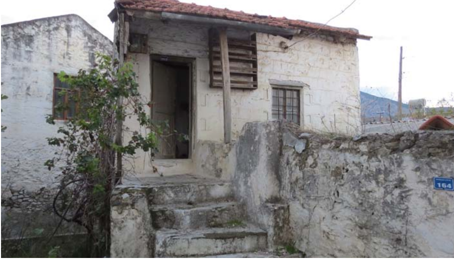
Şekil K.20 : 79 Env.no'lu yapının onarım öncesi durumu (2014).
