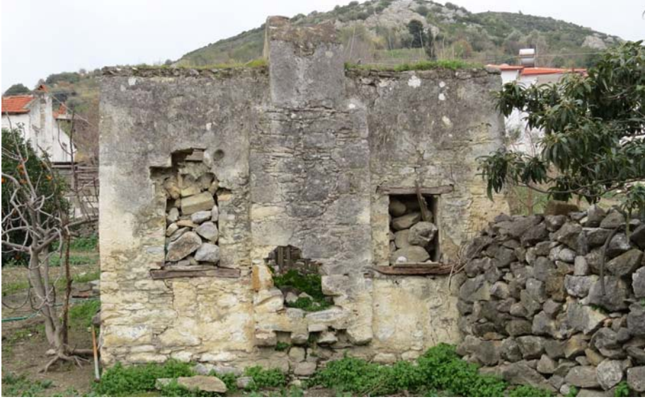
Şekil G.6 : Moloz taş doldurulan pencereler ve baca duvarlarında hasar.
