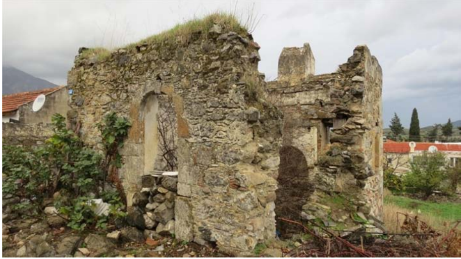
Şekil G.134 : Yıkılan cephe.
