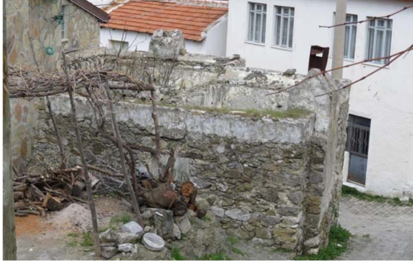
Şekil G.58 : Yok olan düz dam katmanları.
