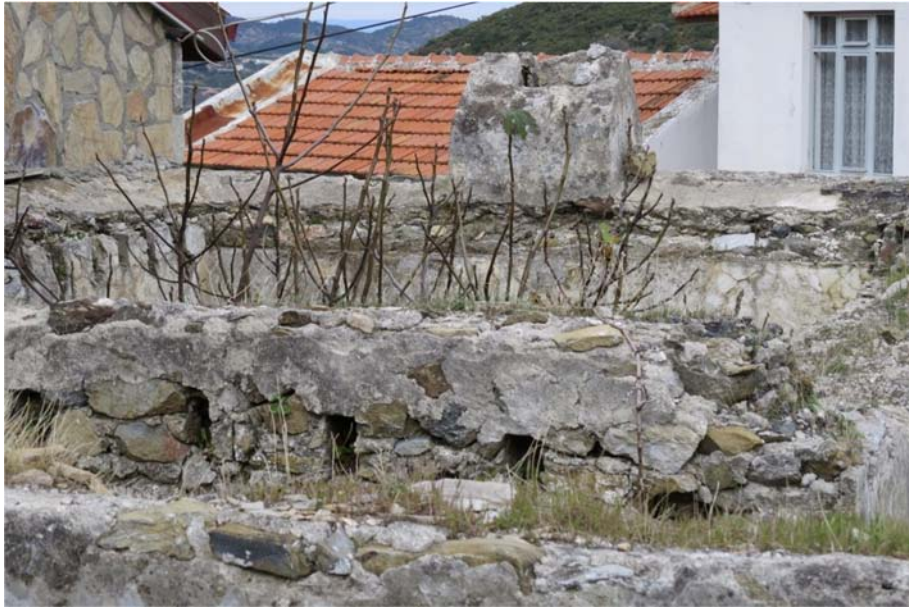
Şekil G.65 : Yıkılan dam katmanlarının görünüşü.
