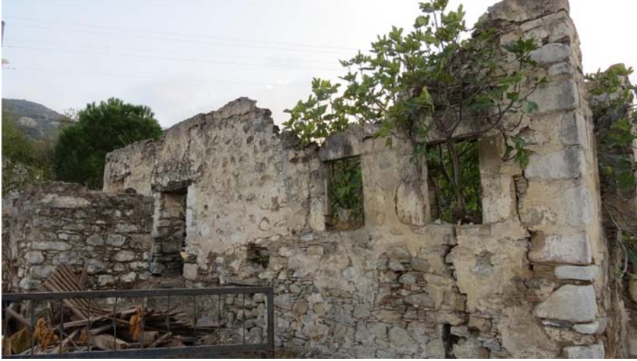
Şekil G.90 : Kuzeydoğu cephesi ve iç mekandan çıkan incir ağacı.
