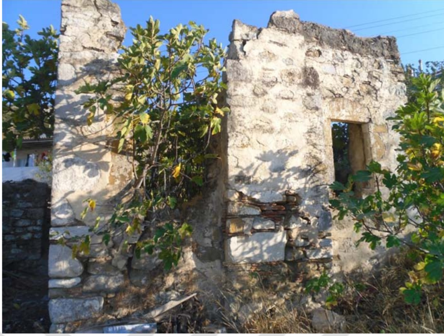
Şekil G.93 : Yıkılan bacalı cephe.
