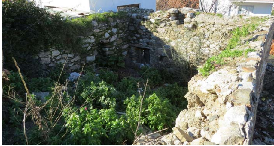
Şekil G.23 : Düz damı yıkılan yapının beden duvarları.
