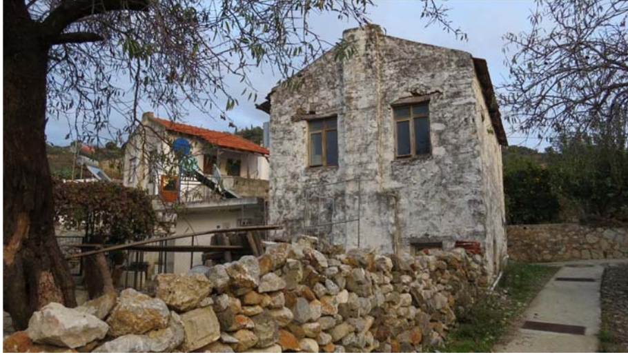
Şekil K.18 : 211 Env. no'lu yapının onarım öncesi durumu (2014).
