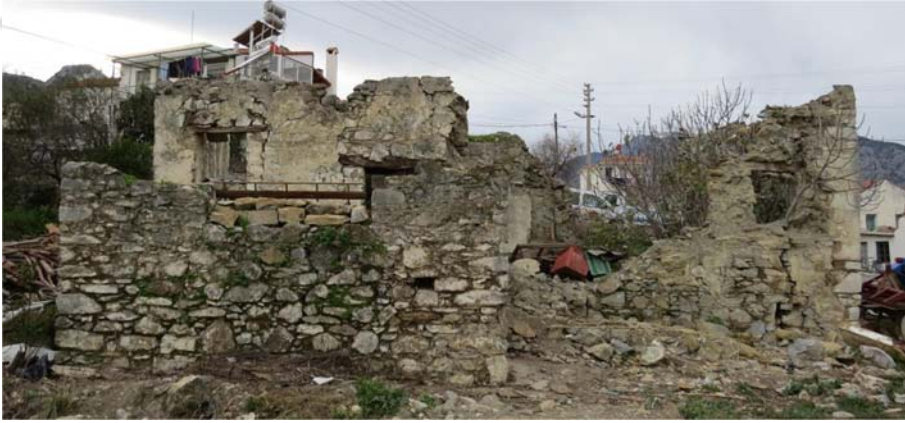
Şekil G.91 : Kuzeydoğu cephesinin 2016'da yıkılan bölümü.
