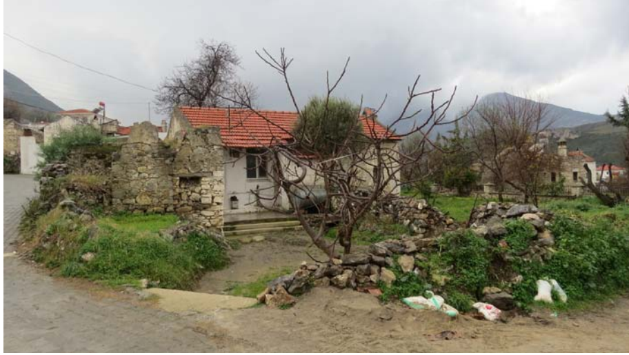
Şekil F.19 : Yıkılan bir yapı ve yeni eki, 39 ve 40 Env. No'lu yapılar.
