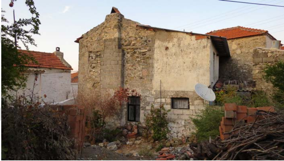
Şekil K.8 : 67 Env. No'lu yapının niteliksiz ekleri.
