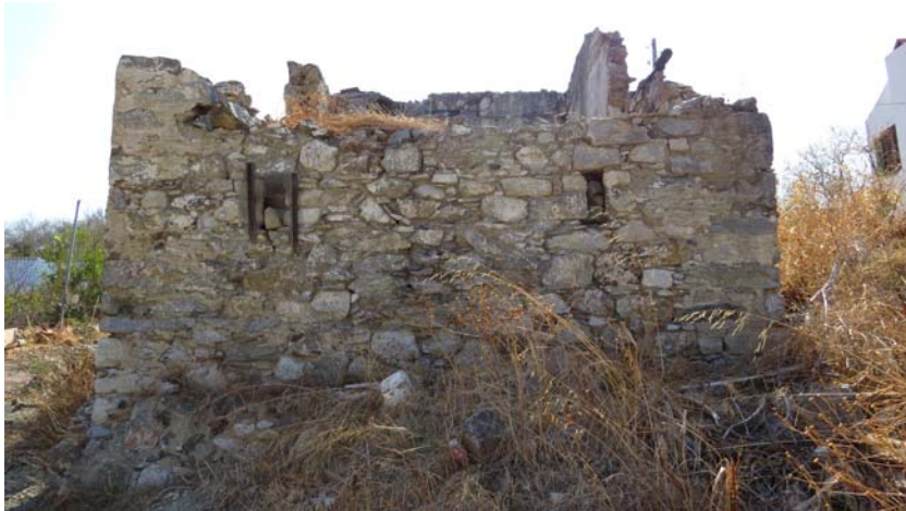
Şekil G.155 : Kuzeybatı cephesi ve bodrum kata menfezler.
