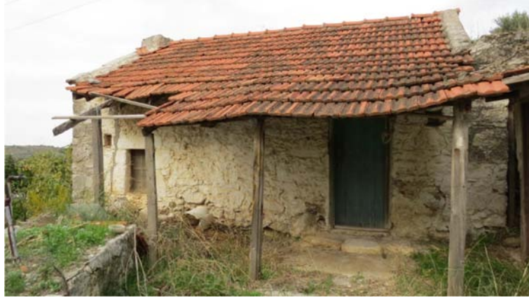
Şekil K.22 : 274 Env.no'lu yapının onarım öncesi durumu (2014).
