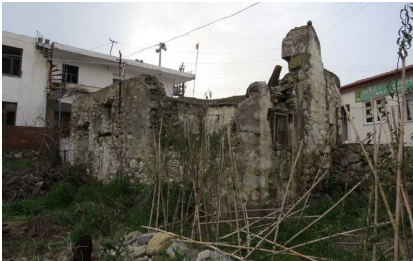
Şekil G.74 : Yıkılan güneydoğu cephesi.
