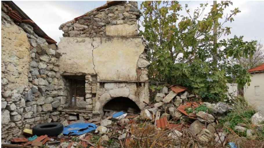
Şekil K.3 : Yıkılan 135 Env. No'lu yapı.
