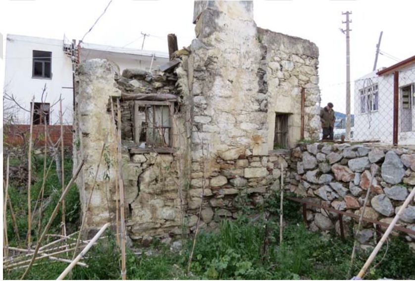
Şekil G.70 : Yıkılan kuzeybatı cephesi ve konsol taşınan baca duvarları.
