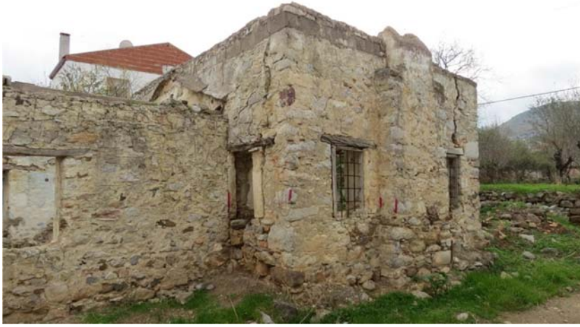
Şekil A.22 : Eski Datça Mahallesi'nde yıkık bir ev.
