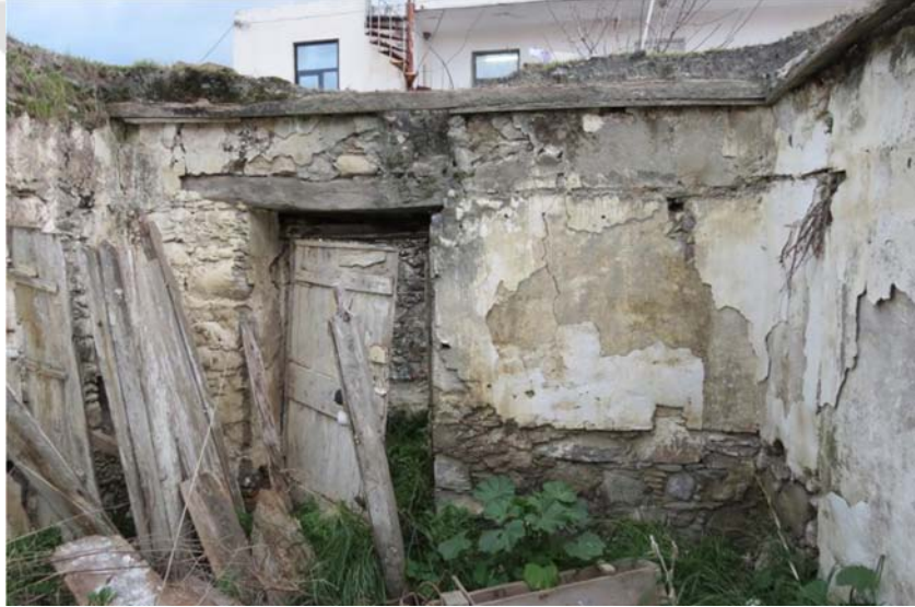
Şekil G.79 : A odasında yıkılan gusülhane ve yüklüğün izi.
