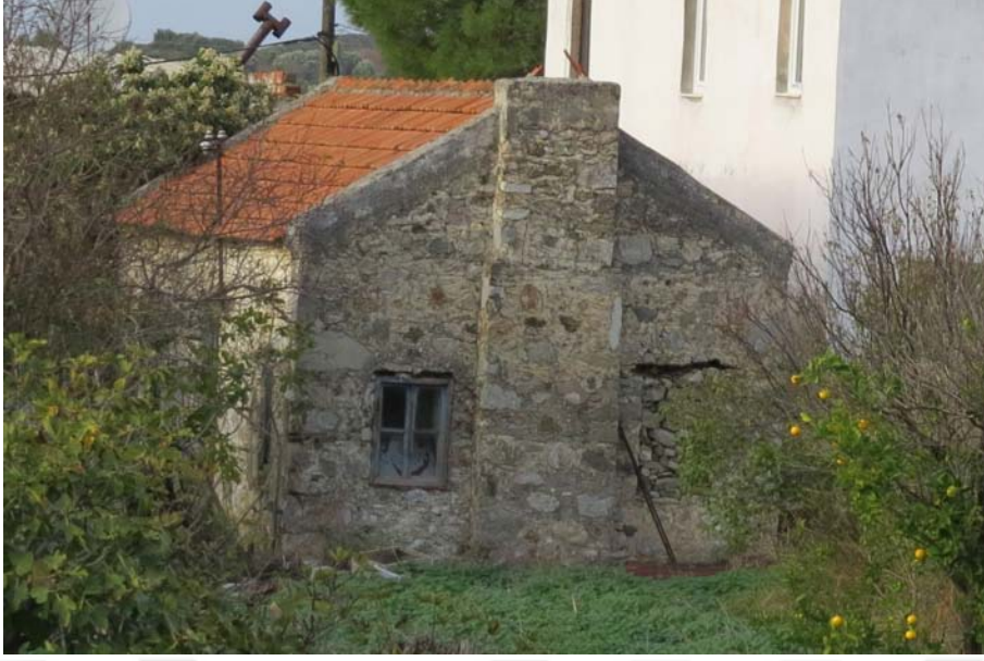
Şekil K.16 : 92 Env.no'lu yapının onarım öncesi durumu (2015).
