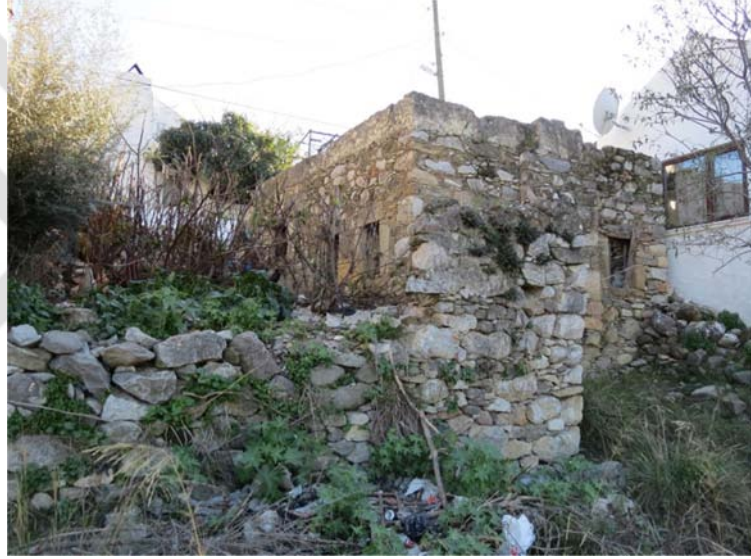
Şekil G.18 : Yapının yıkılan dış avlu duvarları.
