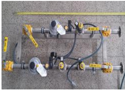
Şekil 5.45 : Gaz besleme, kontrol ve ölçüm sistemleri
