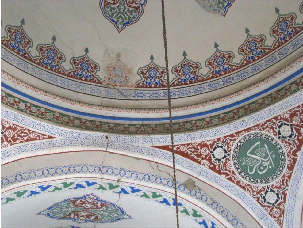
Şekil 4.59 : Atik Mustafa Paşa Camii'nin kubbesindeki çatlaklar (2015).
