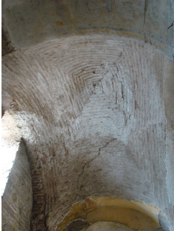
Şekil 4.31 : Aya İrini Müzesi (Ayia İrene Kilisesi)'nin narteksi üzerinde derin çatlaklar (2015).
