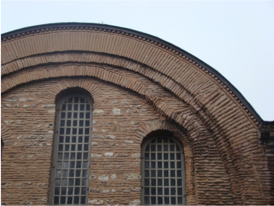
Şekil 4.245 : Kalenderhane Camii (Kyriotissa Meryem Kilisesi)'nin güney cephesindeki kemerdeki çökme (2015)
