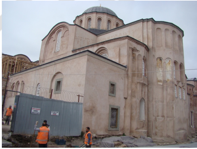
Şekil 4.455 : Zeyrek Kilise Camii (Pantakrotor Manastırı Kilisesi)'nin doğu cephesi (2016).
