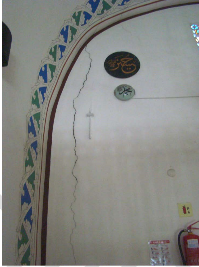
Şekil 4.58 : Atik Mustafa Paşa Camii'nin kuzeybatısındaki çatlak (2015).
