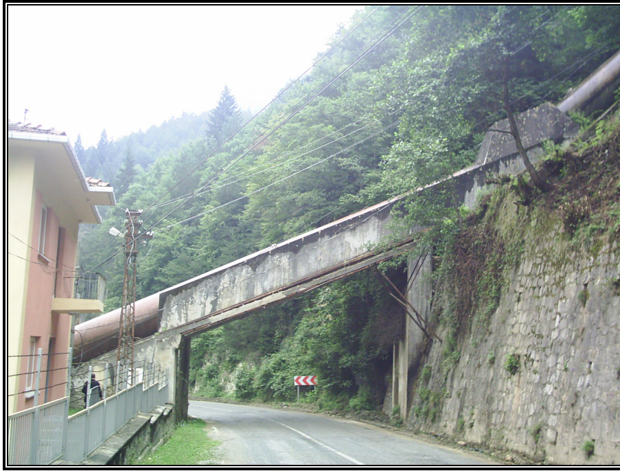
Fotoğraf 3.19. EÜAŞ İkizdere Hidroelektrik Santrali'nde ana havuzla bağlantıyı sağlayan cebri boru 228 karayolunun üzerinden geçirilmiştir.
