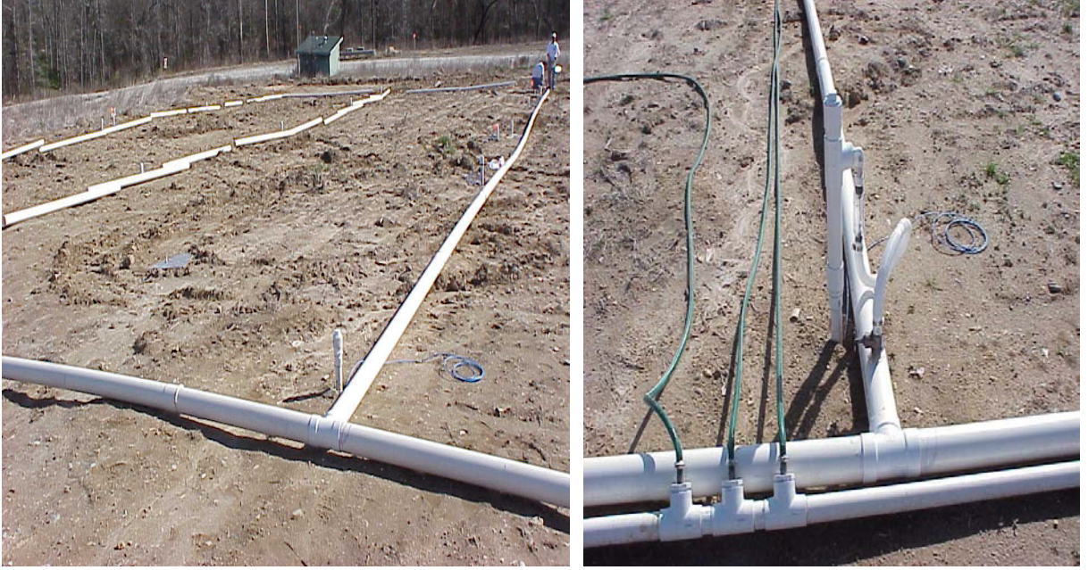
Şekil 2.5 Düzenli depo sahasında havalandırma ve sızıntı suyu geri devir hattının görünümü (ECS, 2005)
