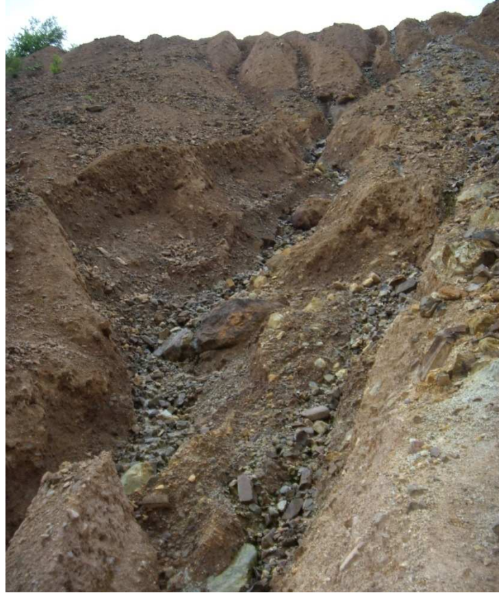
Şekil 3.7. Sızıntıların baraj gövdesinde neden olduğu erozyon sonucu oluşan kanallar.
