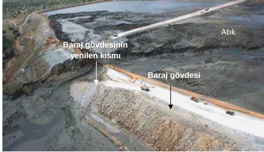
Şekil 2.19. Temelin zayıf olması nedeniyle temel yenilmesi duraysızlığına uğramış Los Frailes (İspanya) madenine ait atık barajı (www.tailings.info, 2009).
