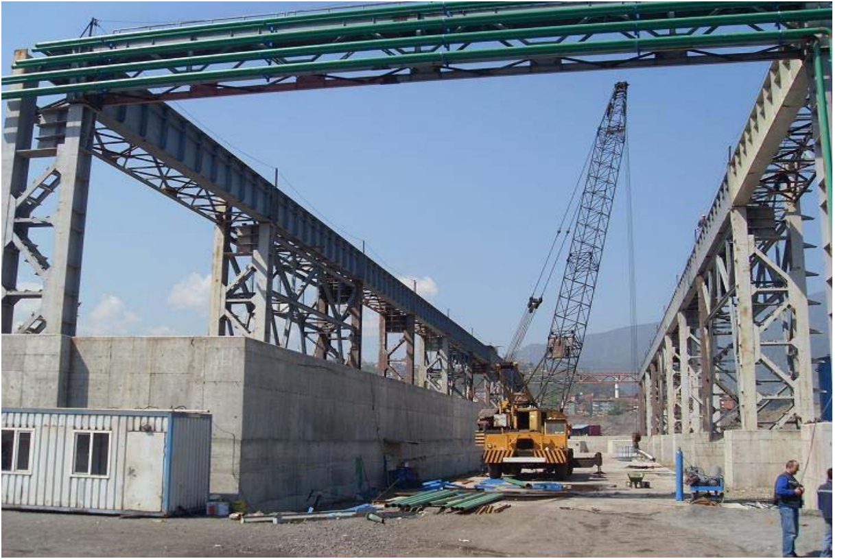
Şekil 4.3 Kardemir demir çelik fabrikası kırma eleme tesisi
