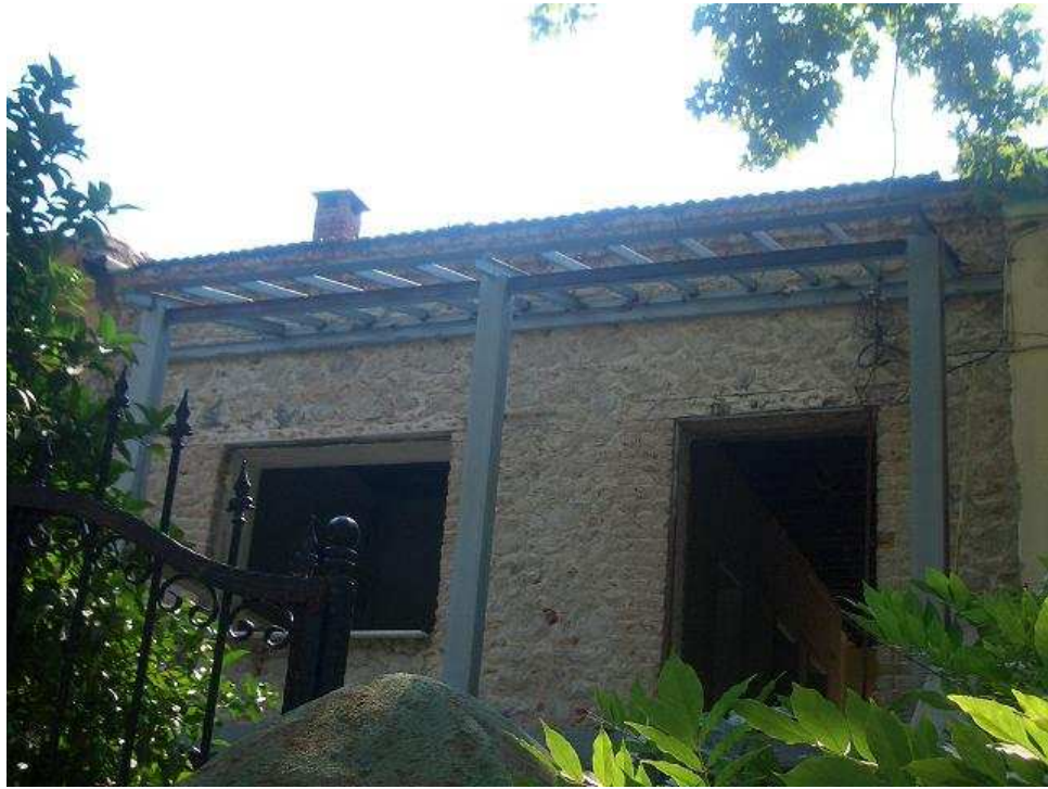
Şekil 6.21 Yığma yapıya sonradan çelik taşıyıcı kısım eklenmesi, Bornova, İzmir.
