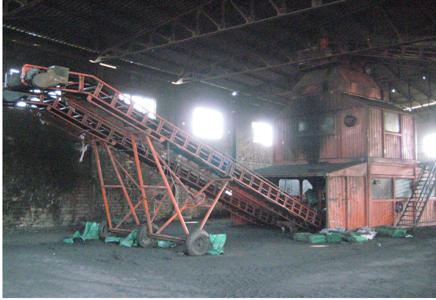
Şekil 5.5. Kömür Torbalama Tesisi
