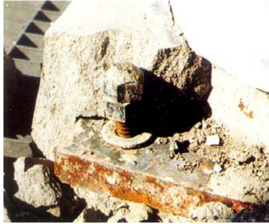
Şekil 2.19 Betona gömülü çelik bulonun ankrajının zayıflığı nedeniyle bulonun açığa çıkması, (Qian ve Li, 2005).
