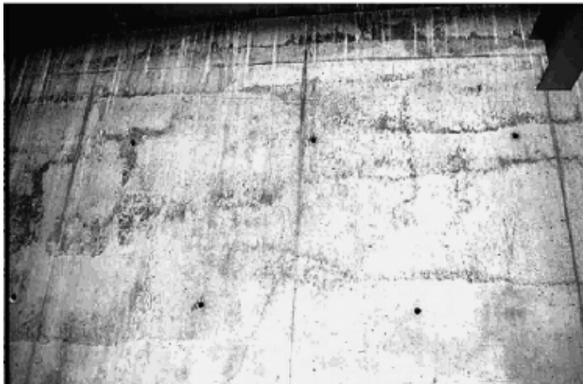
Şekil 3.15 Tiksotropi derecesi yüksek KYB’nin kullanıldığı perdede oluşan soğuk derzler (Roussel ve Cussigh, 2008).
