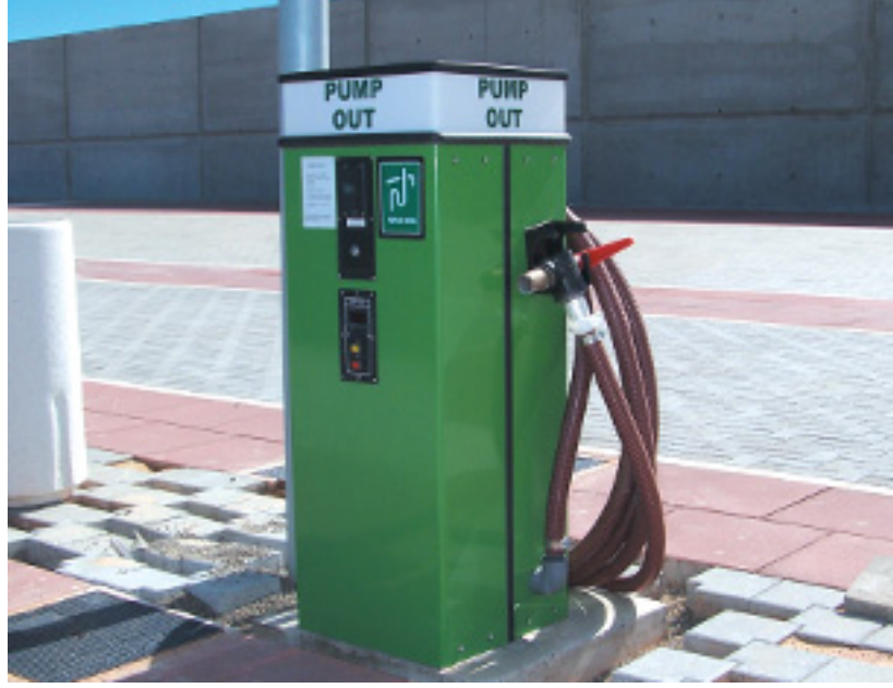
Şekil 4.4: Sıvı Atık Çekme Pompası
