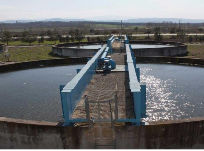
Şekil 1.3. Ön çöktürme havuzu
