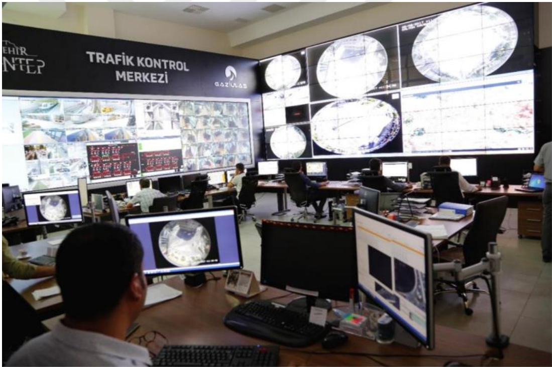
Şekil 3.22 : Gaziantep trafik kontrol merkezi (Gaziantep Büyükşehir Belediyesi akıllı ulaşım sistemleri çalışmaları).
