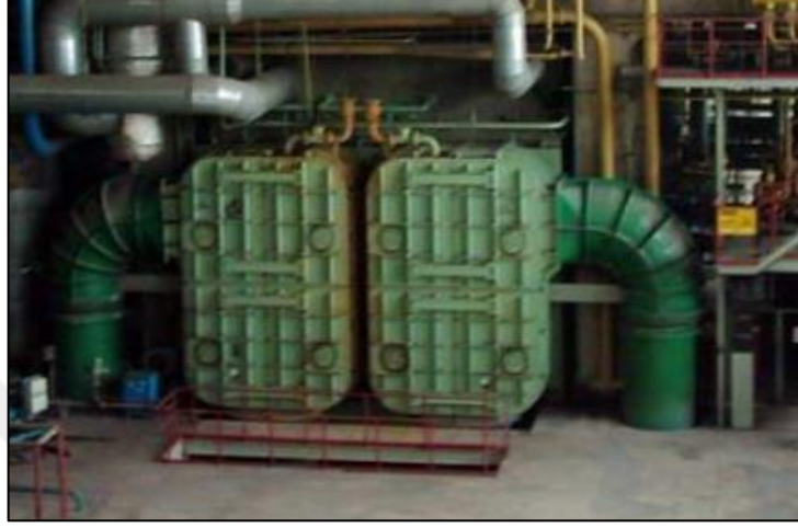
Şekil 1.20. Kondenser genel görünüş
