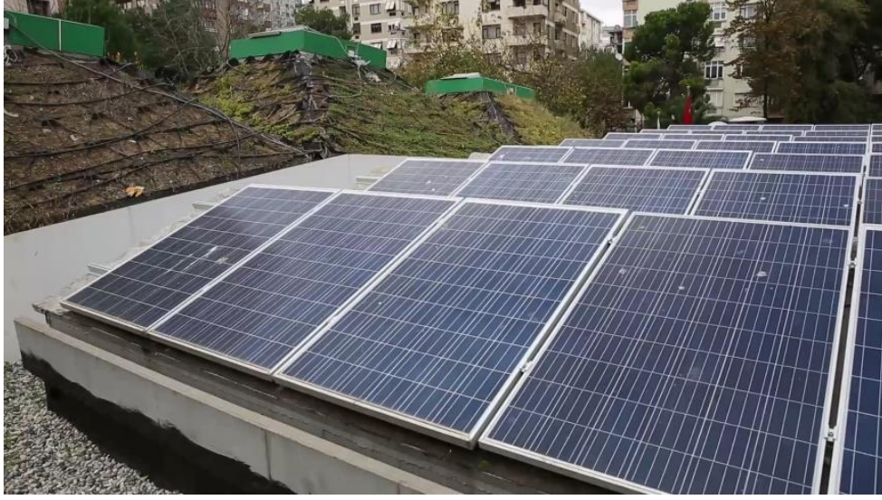
Şekil 79. Elektrik Üreten Güneş Panelleri
