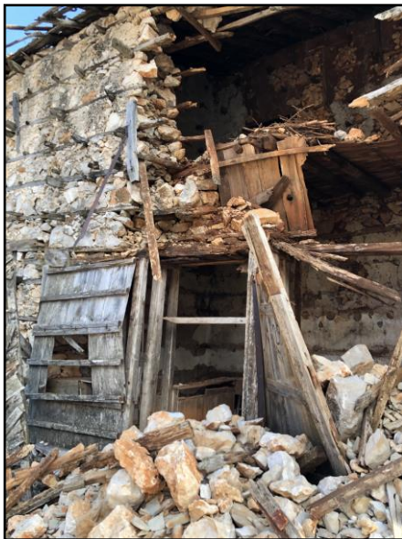
Şekil 98: Kısmi Yıkılmış Yapı
