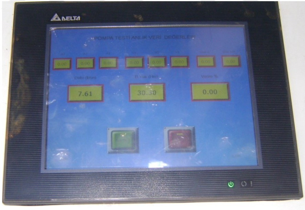
Şekil 3.19. Motopomp Test Düzenine Ait LCD Kontrol Paneli.
