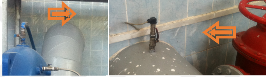
Şekil 3.8. Pompa Giriş ve Çıkışından Basınç Ölçümü Yapılan Manometre ve Basınç Sensörleri.
