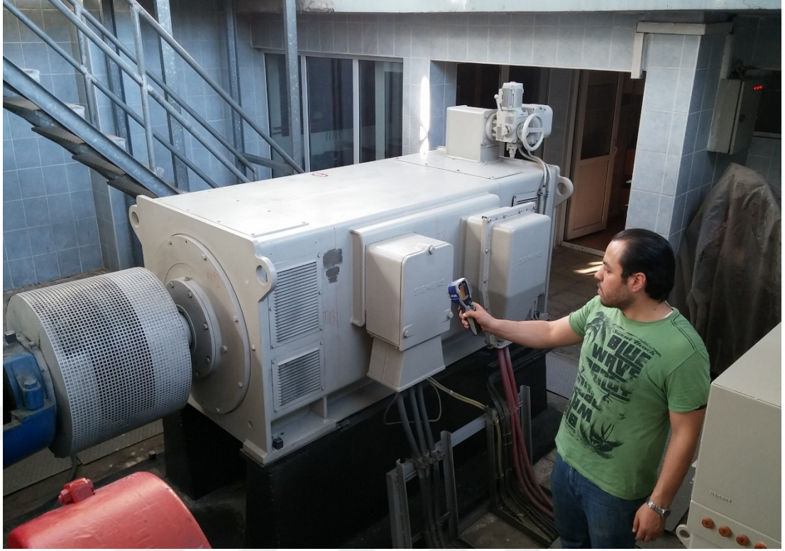
Şekil 3.14. Motor Sıcaklıklarının Termal Kamera ile Ölçümü.
