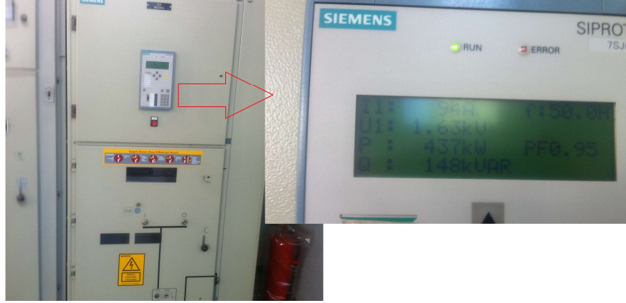
Şekil 3.7. Motor Kumanda Panosu Üzerinden Okunan Motor Çekilen Güç Değeri.
