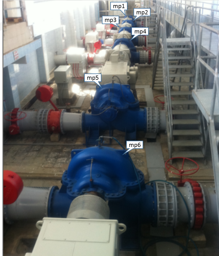
Şekil 3.4. Kâğıthane Terfi Merkezi Bina İçi Görüntüsü.
