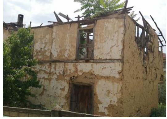
Şekil 4. 7 Çatı hasarları, E012, (Doğan Talyak, 2021)
