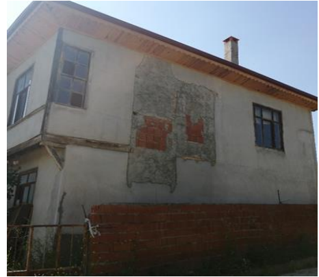
Şekil 4. 11 Yıkılarak kaldırılan ocak ve yunmalık, (E120)
