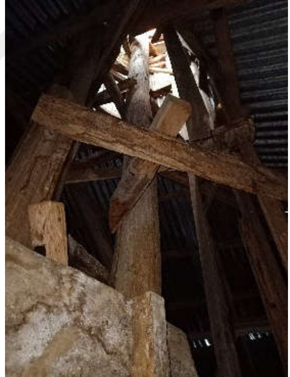
Şekil 71. Koçan Cami minaresinin ahşap iskeleti
