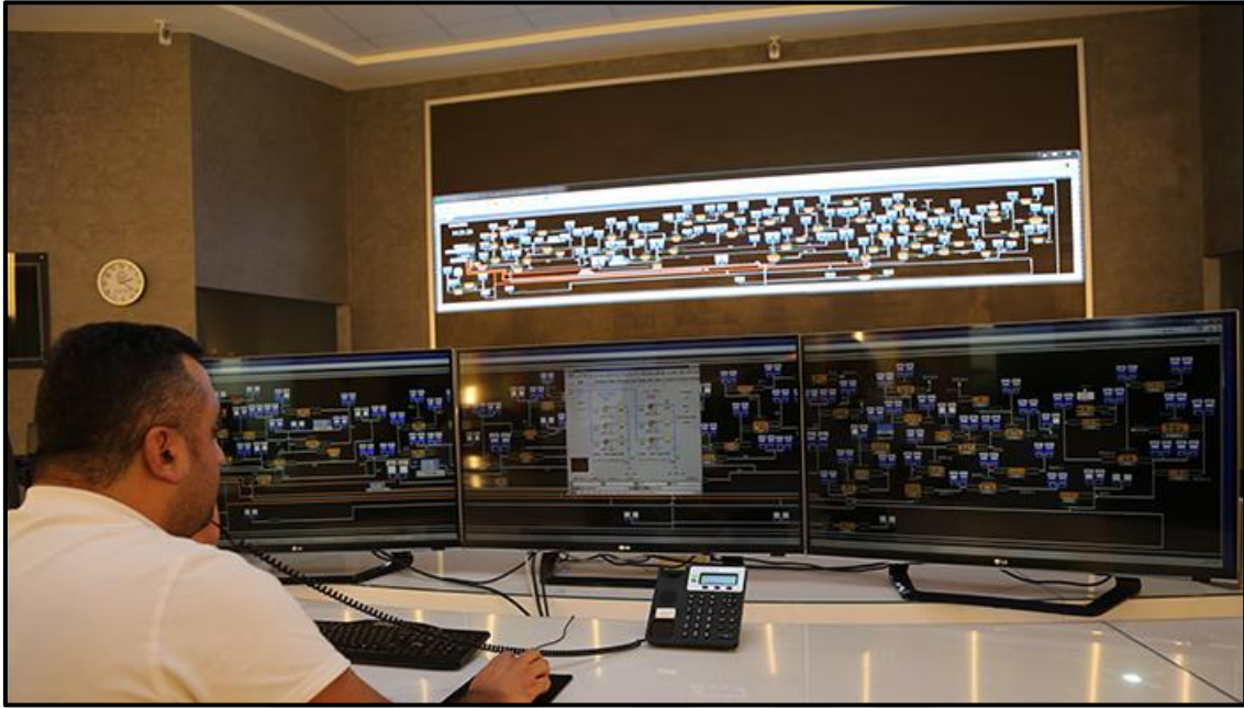
Fotoğraf 15: ASKİ - SCADA Kontrol Merkezi
