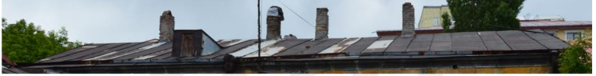
Fotoğraf 23: Ortakapı Mahallesi 304 Numaralı Konutun ( Şehit Yusuf Bey Caddesi ) Çatı Üst Örtüsü Detayı
