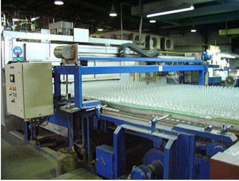
Şekil 2.22: Soğuk Yüzey Kaplama Ünitesi
