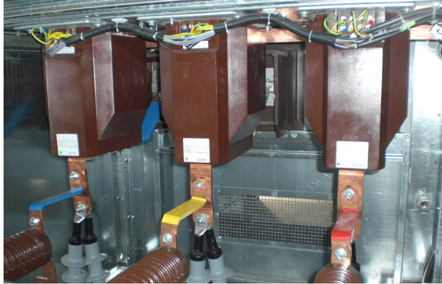
Şekil 2.7. Yüksek gerilim ölçü hücresinde akım ölçü transformatörleri.
