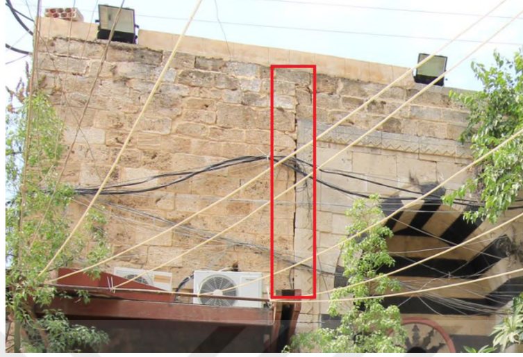
Foto 66. Ekleme yapılan kısma ait dilatasyon izleri
