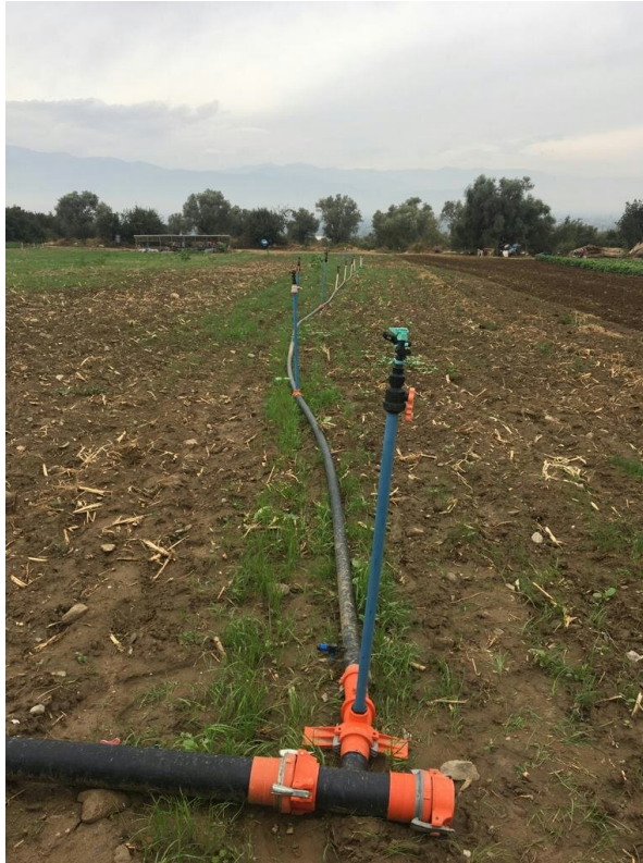
Ėekil 4.6 Ziyaret edilen gnel enerjili pompanın yamurlama ile sulama sistemi
