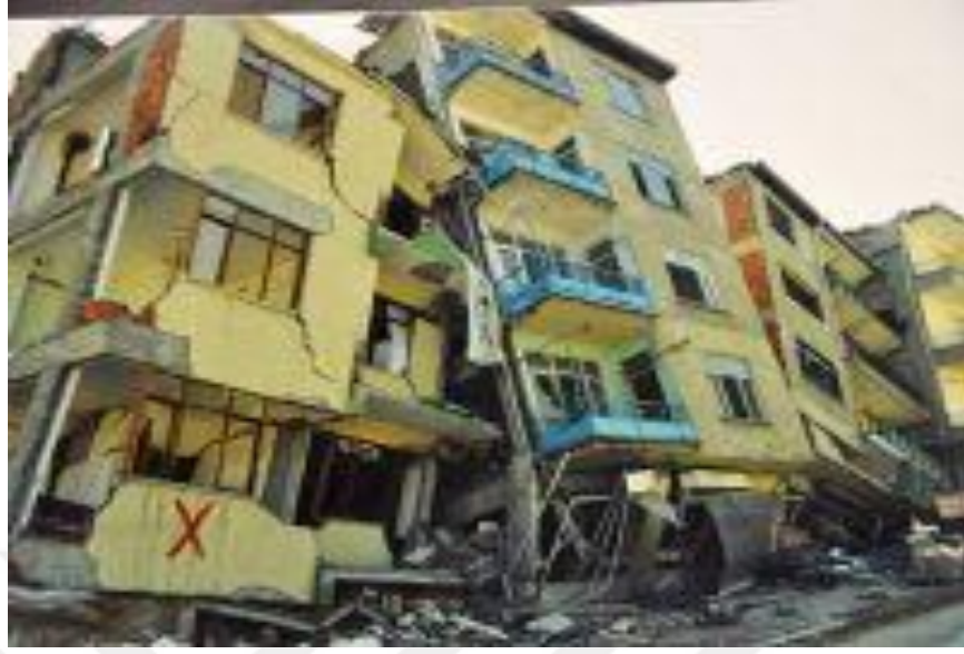
Resim 1.3 17 Ağustos Kocaeli depreminde hasar gören binalar[3]
