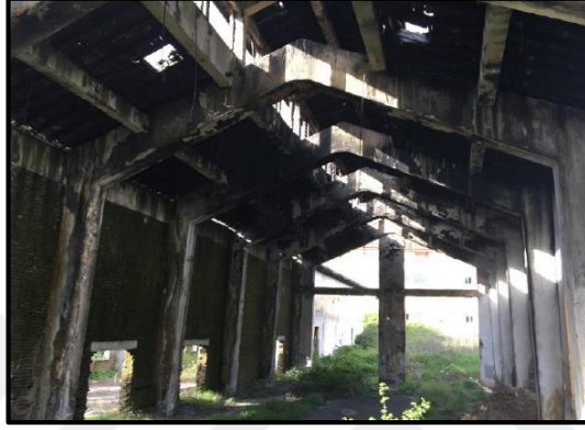
Şekil 4.47. Lokomotif bakım ve onarım atölyesi iç mekan görünüş (Yıldız , 2019)
