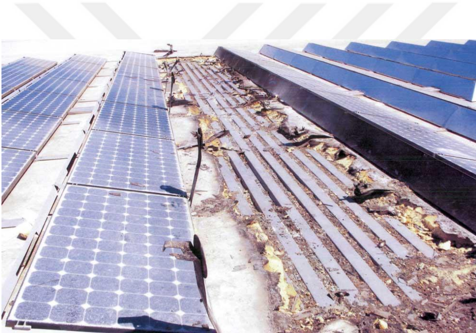
Şekil 1.1. Bakersfield, California güneş santrelinde arıza nedeniyle oluşan yangın sonucunda oluşan tahribat.
