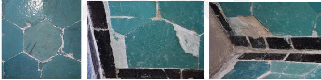
Resim 5. 275. Hankah, güney eyvan, sol duvar, yüzey boya ayrılmaları ve solmaları. Resim 5. 276. Hankah, güney eyvan, sol duvar, sağ alt köşe, yüzey boya ayrılmaları ve solmaları. Resim 5. 277. Hankah, güney eyvan, sol duvar, sol alt köşe, yüzey boya ayrılmaları ve solmaları
