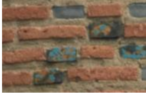
Resim 5. 127. Mescit, minare gövde, kuzey cephe, yüzey kirlilik/ is tabakası.
