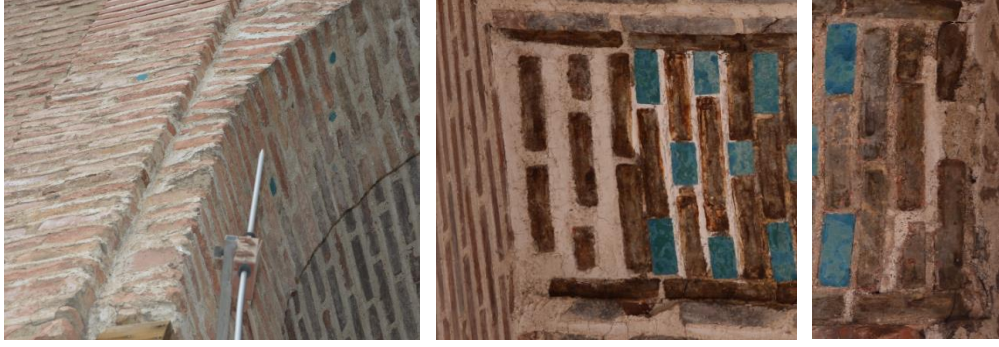
Resim 5. 143.Mescit, kuzey sivri kemer ve silme, birim malzeme kaybı.
