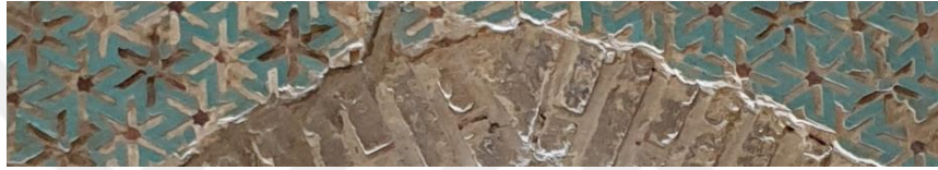
Resim 5. 481. Medrese, 8 no.lu pencere sivri kemer ve alınlık birleşme yüzeyi, parça kaybı
