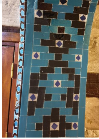
Resim 5. 342. Türbe, sivri kemerli geçiş kapı, doğu taraf, birim malzeme kaybı.
