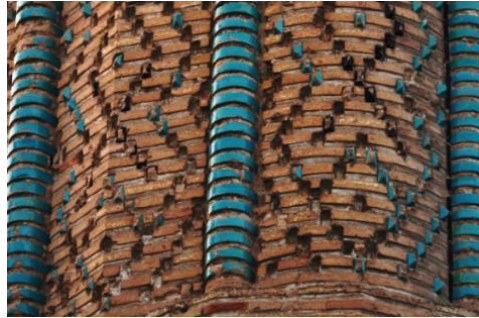
Resim 5. 456. Medrese, minare, güney cephe, birim malzeme kaybı.
