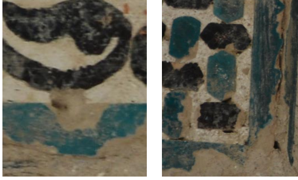
Resim 5. 48 Türbe eyvan, doğu duvar, 5 no. lu çiniler, parça kaybı.
