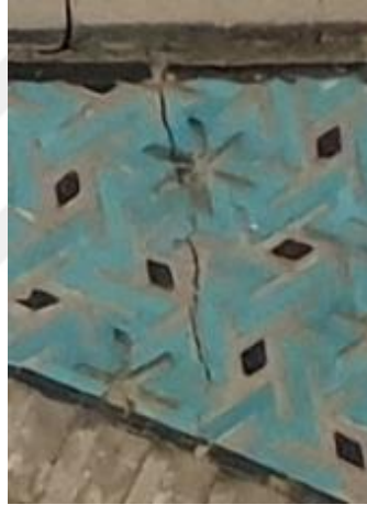
Resim 5. 479. Medrese, 11 no.lu pencere köşelik çinisi, çatlak.
