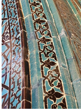
Resim 5. 361. Tübe, sivri kemer, doğu yüz, kuzey taraf, çatlak.
