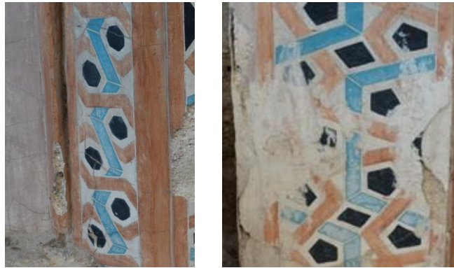
Resim 5. 569. Mescit, kapı açıklığı, sağ (kuzey) taraf, alt kısım, yüzey-boya ayrılmaları ve solmaları. Resim 5. 570. Mescit, kapı açıklığı, sol (güney) taraf, alt kısım, yüzey-boya ayrılmaları ve solmaları.
