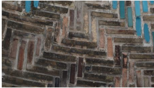
Resim 5. 495. Medrese, kubbe, batı cephe, sırsız tuğlalarda birim malzeme kaybı.
