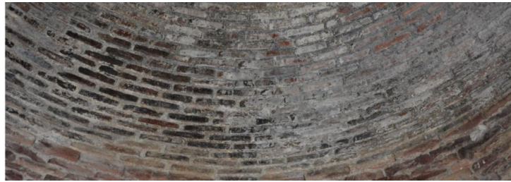
Resim 5. 87. Türbe, kubbe, beyaz badana yüzeyinde dökülmeler.
