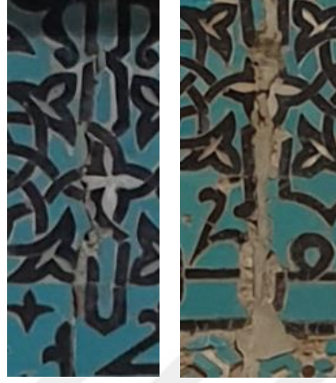
Resim 5. 475. Medrese, 10 no.lu pencere alınlık çinisi, çatlak.
