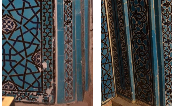
Resim 5. 357. Türbe, sivri kemer, kuzey taraf, birim malzeme kaybı.
