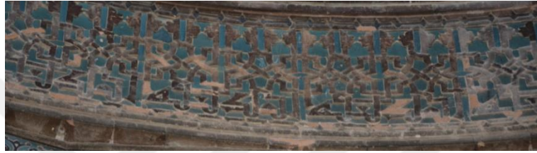
Resim 5. 488. Medrese, kubbe kasnağı, kuzey-doğu cephe, birim malzeme kaybı
