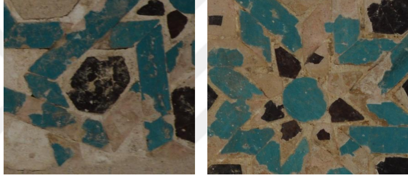
Resim 5. 50. Türbe eyvan, doğu duvar, 8 no. lu çiniler, parça kaybı.
