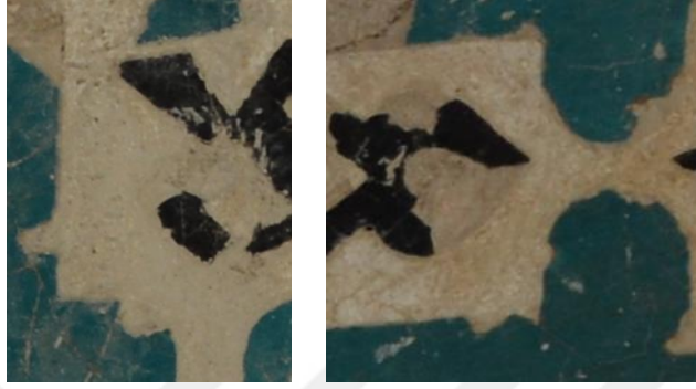
Resim 5. 44. Türbe eyvan, doğu duvar, 1 no. lu çiniler, parça kaybı.
