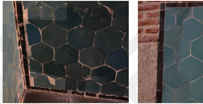
Resim 5. 258. Hankah, güney eyvan, sağ(batı) duvar sol alt köşe, parça kaybı.
