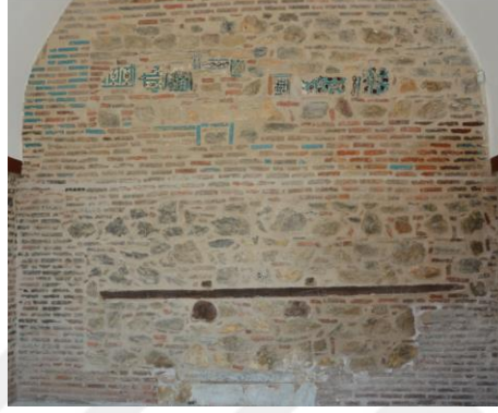
Resim 5. 31. Tübe eyvan, doğu duvar, taşıyıcı sorunu.
