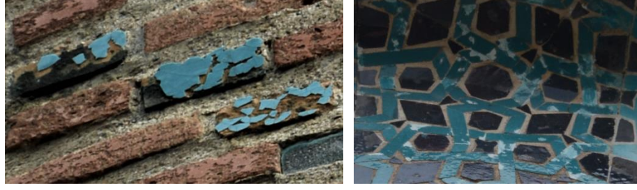
Resim 5. 123. Mescit, minare gövde kısmı, doğu cephe, parça kaybı.
