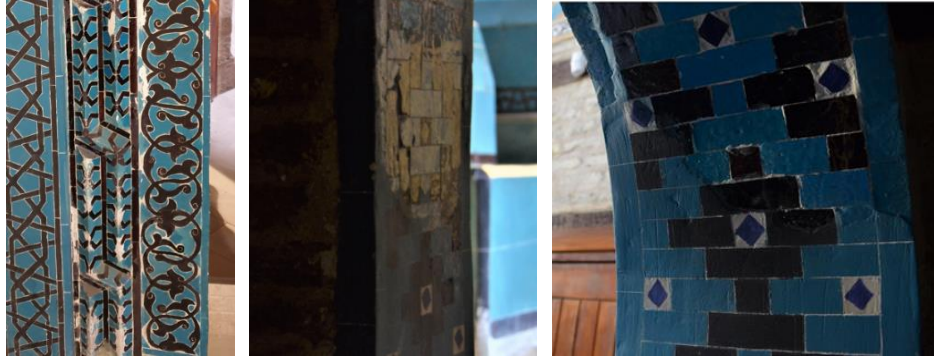
Resim 5. 343. Türbe, sivri kemerli geçiş kapı, doğu taraf, parça kaybı.
