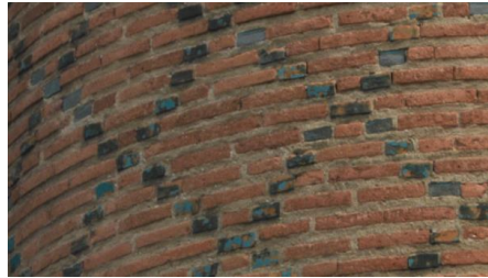
Resim 5. 126. Mescit, minare gövde, kuzey cephe, yüzey kirlilik/ is tabakası oluşumu.
