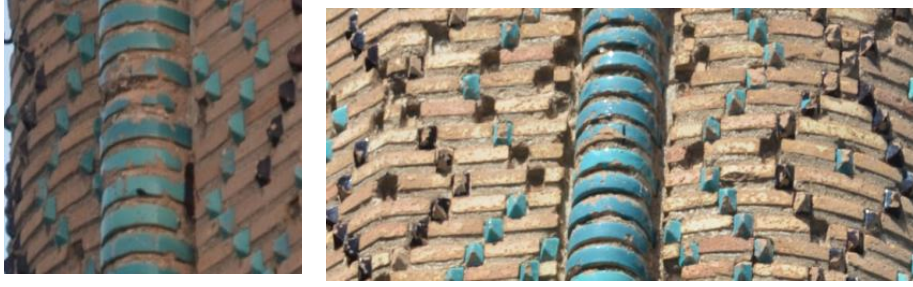
Resim 5. 462. Medrese, minare dilimli gövde, güney cephe silme, parça kaybı.
