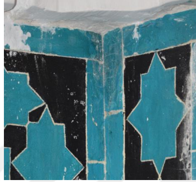
Resim 5. 575. Mescit, son cemaat yeri, güney duvar, mukarnaslı pencere, sağ üst köşe, birim malzeme kaybı.
