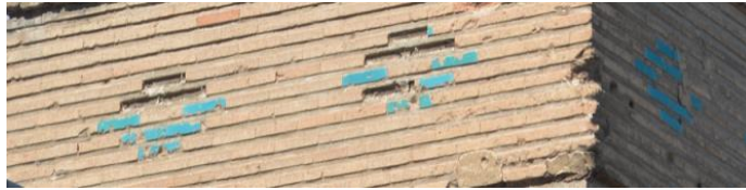
Resim 5. 461. Medrese, minare kaide kısmı, güney ve doğu cephe, parça kaybı.
