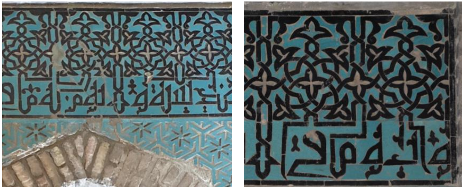
Resim 5. 469. Medrese, 3 no.lu pencere alınlığı, birim malzeme kaybı.
