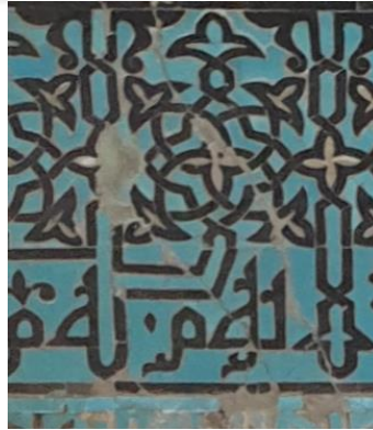
Resim 5. 477. Medrese, 3 no.lu pencere alınlık çinisi, çatlak.
