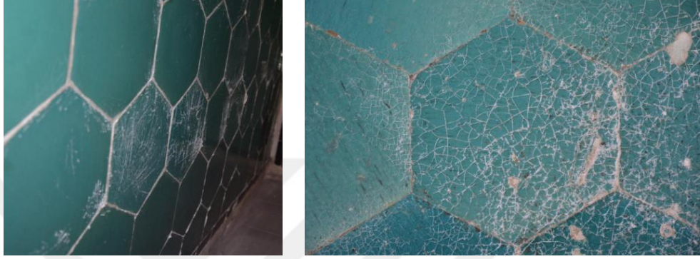
Resim 5. 265. Hankah, güney eyvan, sağ duvar sol köşe, tuzlanma detay.
