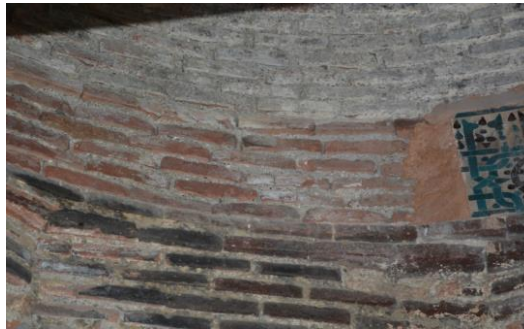
Resim 5. 60. Medrese, kubbe kasnağı, birim malzeme kaybı.
