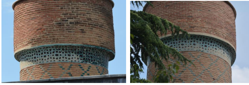
Resim 5. 118. Mescit, minare gövde kısmı, güney-doğu ve doğu cephe, birim malzeme kaybı.
