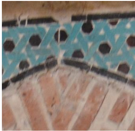
Resim 5. 288. Hankah, güney-batı cephe, pencere şebekesi, parça kaybı.
