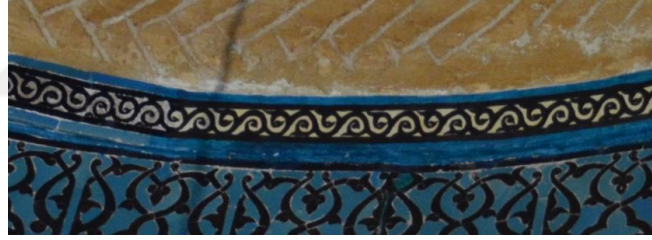
Resim 5. 393. Türbe, kubbe kasnağı, turkuaz şeritler, birim malzeme kaybı.
