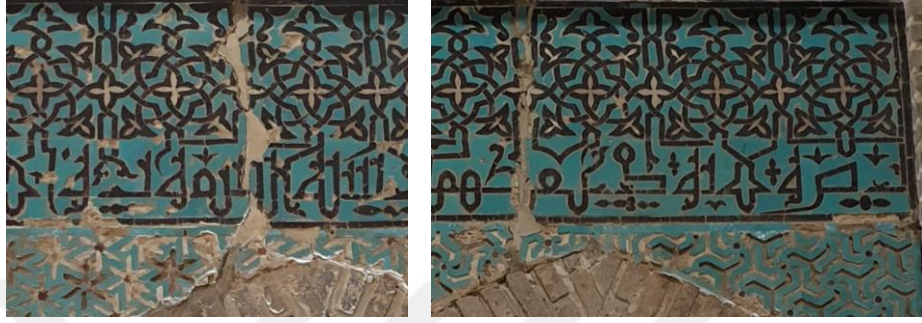
Resim 5. 471. Medrese, 8 no.lu pencere alınlığı, birim malzeme kaybı.
