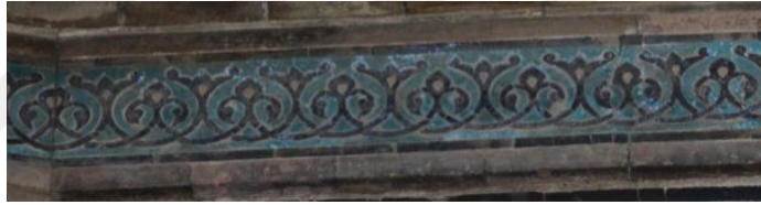
Resim 5. 511. Medrese, yirmi gen kuşak, güney cephe, yüzey kirlilik.
