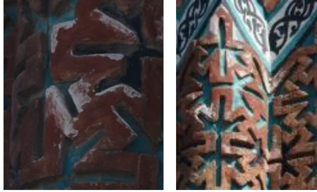
Resim 5. 208. Minare, dilimli gövde, doğu taraf, tuzlanma.
