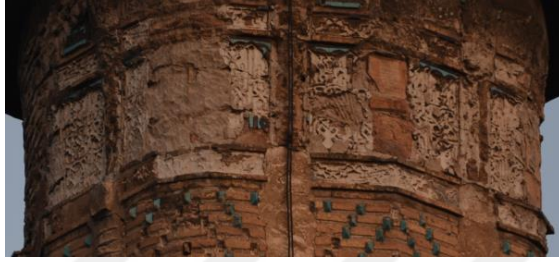
Resim 5. 460. Medrese, minare kuzey ve batı cephe, pano bağlantı/derz malzeme sorunları
