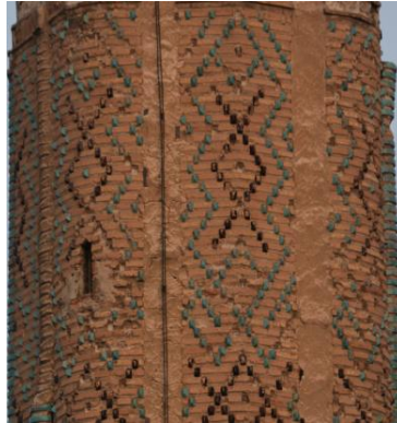
Resim 5. 459. Medrese, minare, batı ve kuzey-batı cephe, birim malzeme kaybı.
