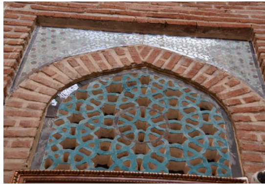
Resim 5. 283. Hankah, güney-doğu cephe, pencere şebekesi, birim malzeme kaybı.
