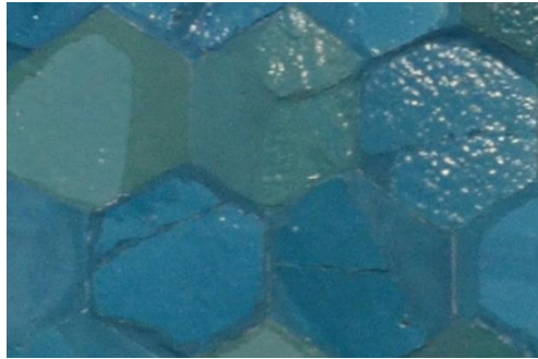
Resim 5. 262. Hankah, kuzey eyvan, ana eyvana bakan sol duvar, kırık.
