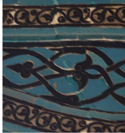
Resim 5. 360. Tübe, sivri kemerli geçiş kapı, doğu yüz, birim malzeme kaybı.
