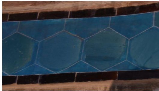
Resim 5. 379. Türbe güney duvar, pencere üstü, parça kaybı.
