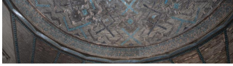
Resim 5. 487. Medrese, kubbe kasnağı, doğu cephe, birim malzeme kaybı.
