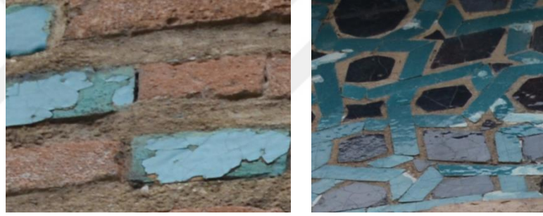
Resim 5. 120. Mescit, minare gövde kısmı, güney cephe, çatlak.
