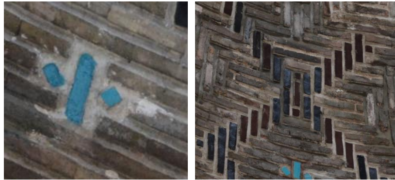
Resim 5. 497 Medrese, kubbe, batı cephe, birim malzeme kaybı, detay.
