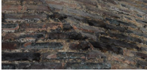
Resim 5. 78. Türbe, Türk üçgenleri, doğu cephe, yüzey kirlilik/ is tabakası oluşumu.
