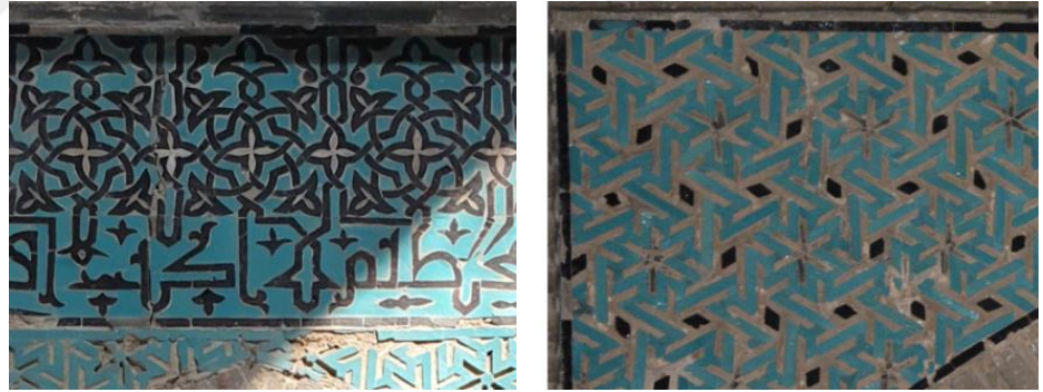
Resim 5. 473. Medrese, 10 no.lu pencere alınlığı, birim malzeme kaybı.
