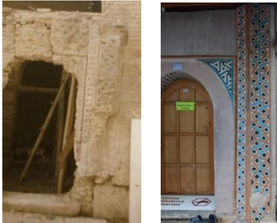
Resim 5. 562. Mescit, kapı açıklığı (V.B.M.), taşıyıcı sorunları.
