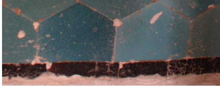
Resim 5. 260. Hankah, Batı eyvan, Ana eyvana bakan sağ duvar, Özgün çini alt kısım, Çatlak.
