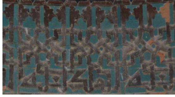
Resim 5. 510. Medrese, kubbe kasnak, kuzey-doğu cephe, renk bozulması.
