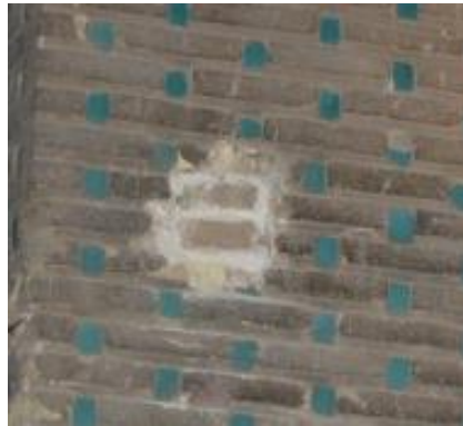
Resim 5. 486. Medrese, batı eyvan sivri kemer, karın kısmı, birim malzeme kaybı.
