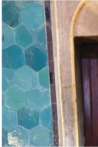
Resim 5. 373. Törbe, batı duvar, kapı sol taraf, Birim malzeme kaybı
