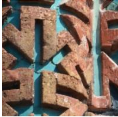
Resim 5. 207. Minare, dilimli gövde, batı taraf, çatlak-kırık.
