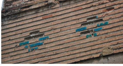
Resim 5. 454. Medrese, minare kaide kısmı, güney cephe, birim malzeme kaybı.
