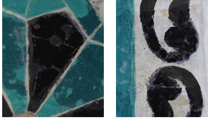
Resim 5. 163. Mescit, kubbe göbek, çatlak.
