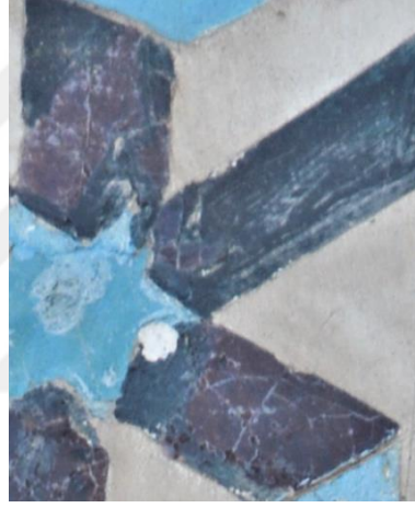
Resim 5. 577. Mescit, doğu cephe, pencere köşelik, sol (güney) taraf, çatlak.
