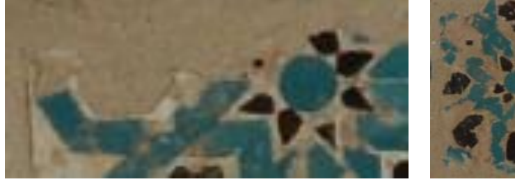
Resim 5. 38. Türbe eyvan, doğu duvar, 8 no. lu çiniler, birim malzeme kaybı.
