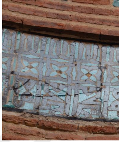
Resim 5. 300. Hankah, kubbe kasnak, güney-batı eyvan üstü, çini pano, çatlak-kırık.
