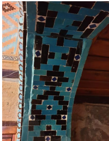
Resim 5. 352. Türbe, geçiş kapı kemeri karnı üst kısmı, tamamlama.
