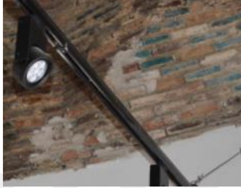
Resim 5. 59. Türbe, Türk üçgenleri, doğu cephe, birim malzeme kaybı.
