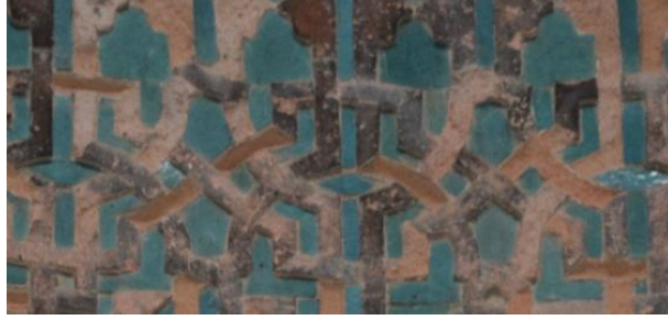
Resim 5. 499. Medrese, kubbe kasnağı, doğu cephe, aşınma-ufalanma.
