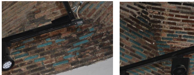
Resim 5. 75. Türbe, Türk üçgenleri, kuzey-doğu cephe, yüzey kirlilik/ is tabakası oluşumu. Resim 5. 76. Türbe, Türk üçgenleri, kuzey-batı cephe, yüzey kirlilik/ is tabakası oluşumu.
