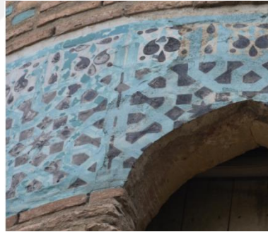
Resim 5. 117. Mescit, minare ikinci kuşak, güney cephe, birim malzeme kaybı.
