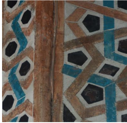
Resim 5. 564. Mescit, kapı açıklığı, kuzey taraf, birim malzeme kaybı.
