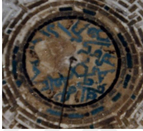
Resim 5. 586. Mescit, kubbe göbeği, birim malzeme kaybı (V.B.M.).
