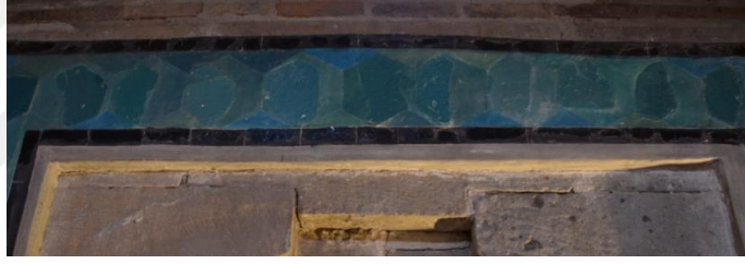
Resim 5. 372. Törbe, Batı duvar, kapı üstü, Birim malzeme kaybı.
