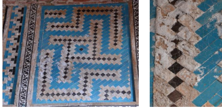
Resim 5. 350. Türbe, giriş koridor, kuzey üst pano, yüzeysel tabaka oluşumu/ çiçeklenme tuzlanma. Resim 5. 351. Yüzeysel tabaka oluşumu/ çiçeklenme tuzlanma- detay.
