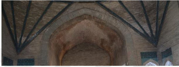
Resim 5. 528. Medrese, ana eyvan ve batı cephe üçgen bingiler, nem.
