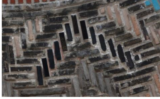
Resim 5. 496. Medrese, kubbe, güney-batı cephe, kahverengi sırlı tuğlalarda birim malzeme kaybı
