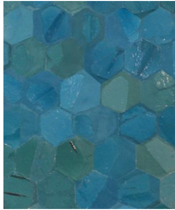
Resim 5. 256. Hankah, kuzey eyvan, arka duvar, sol pano çinileri, parça kaybı.
