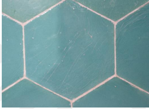
Resim 5. 261. Hankah, batı eyvan, sol duvar, çatlak.
