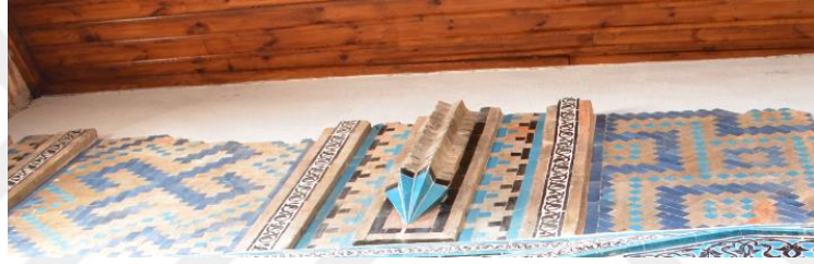
Resim 5. 339. Türbe, giriş koridor, batı duvar, taşıyıcı sorunu.
