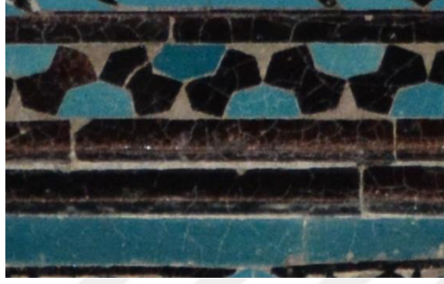
Resim 5. 678. Mescit, mihrap kuşak, çatlak.
