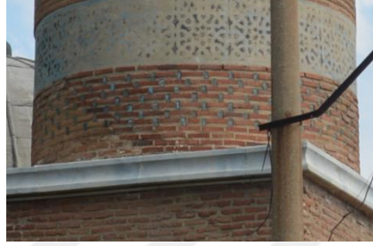
Resim 5. 116. Mescit, minare birinci kuşak, kuzey, kuzey-batı cephe, birim malzeme kaybı.
