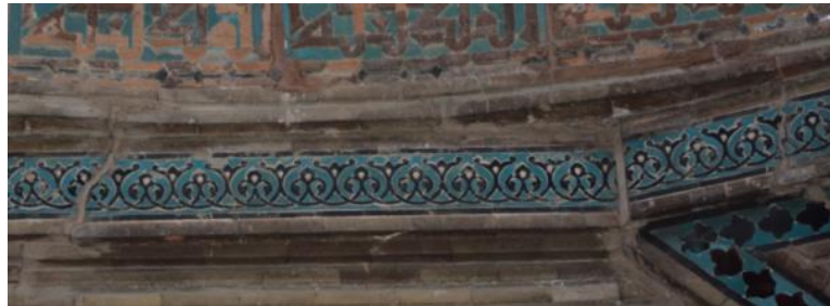
Resim 5. 502. Medrese, kubbe yirmigen kuşak, batı cephe, çatlak-kırık.
