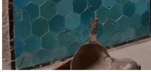
Resim 5. 257. Hankah, kuzey eyvan, sol (batı) duvar pano çinileri, parça kaybı.
