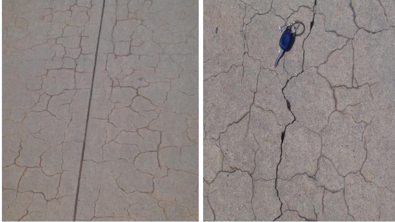
Şekil 2.8 Adnan Menderes Havalimanı pist ve taksi yollarında ASR çatlakları (Andiç-Çakır et al., 2012, Ramyar, 2013).
