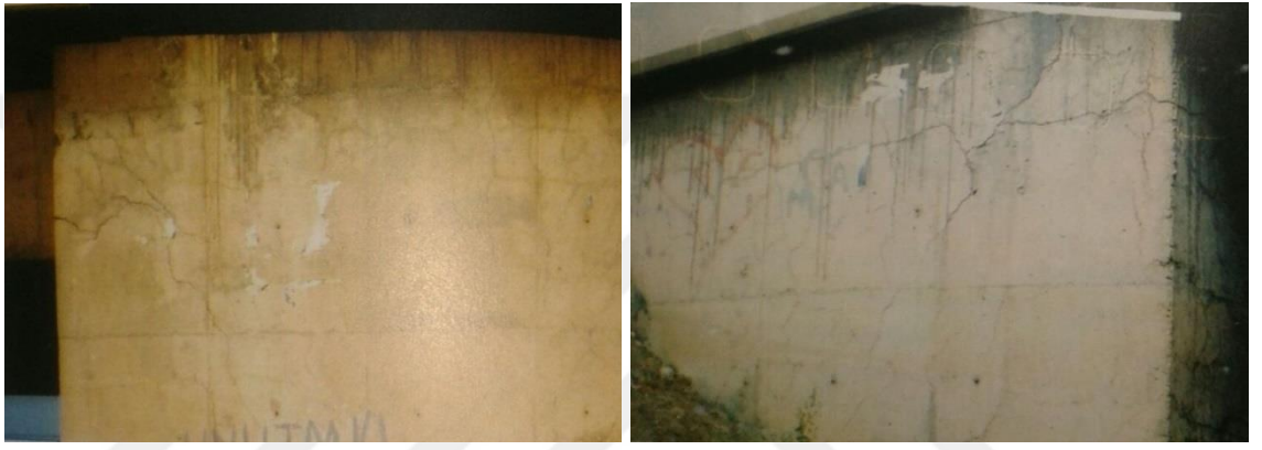
Şekil 2.6 İzmir’de ASR hasarına uğramış köprü ayakları (Baradan vd., 2010).
