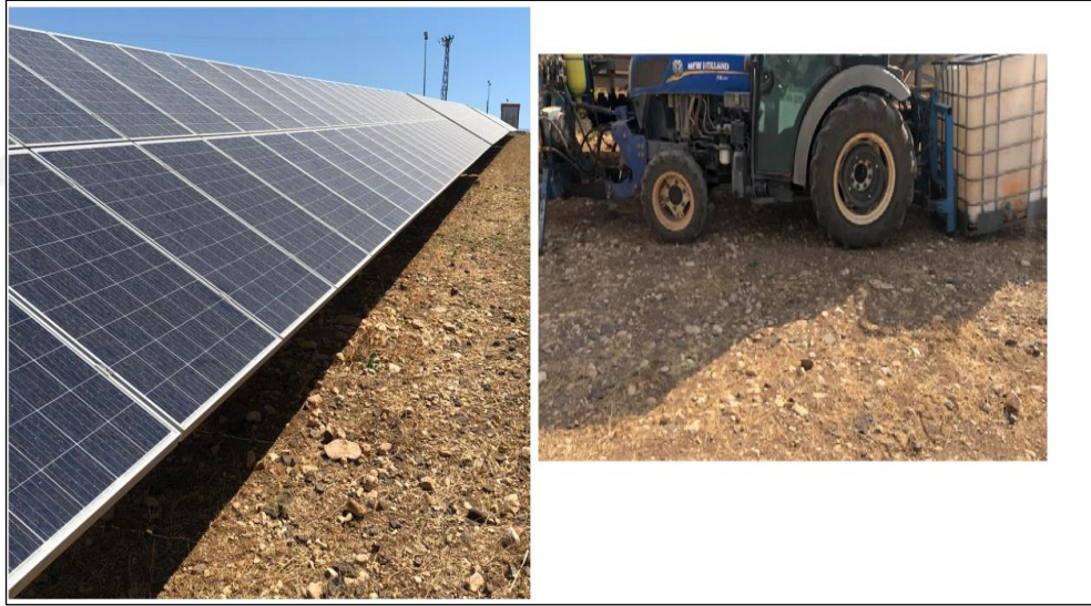
Şekil 3.39. Araştırma sahası olan 1 MW kurulu güçteki bölücek GES panel temizliği görselleri
