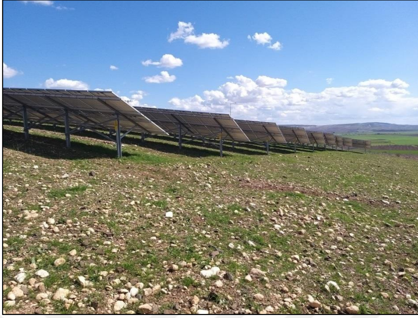
Şekil 3.6. Panellerin konumlandırıldığı GES sahası genel görünümü
