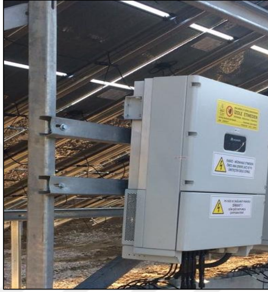
Şekil 3.8. Taşıyıcı sisteme monte edilmiş halde bulunan invertör görüntüsü (veri sistem elemanı)
