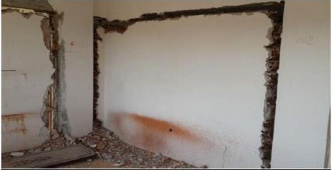
Şekil 54. Duvar çerçeve etkileşiminin kesilmesi sonrasında görünüş (Aras, 2018b)
