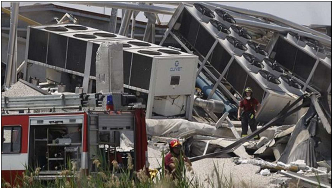
Şekil 1.2: Depremde hasar görmüş fabrika binası.
