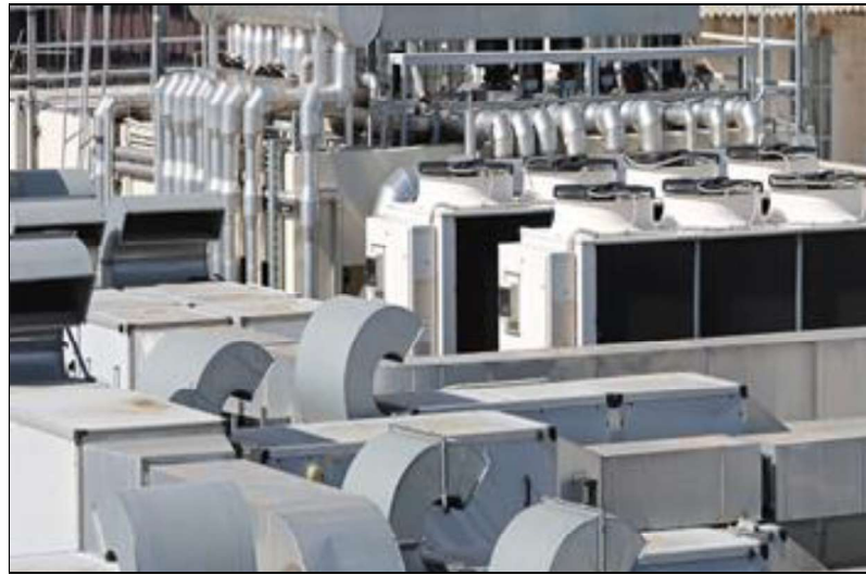
Şekil 5.27: Bina çatısına konulan merkezi havalandırma sistemi.
