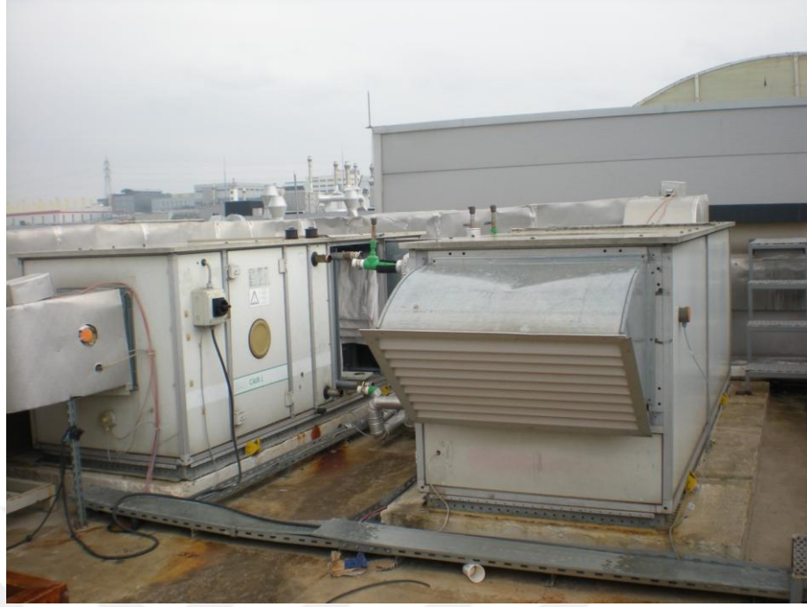
Şekil 3.29. İdari bina yemekhane klima santrali.
