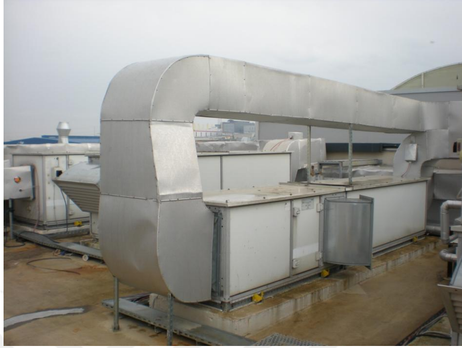
Şekil 3.27. İdari bina -3 ve +1 kotuna ait klima santrali.
