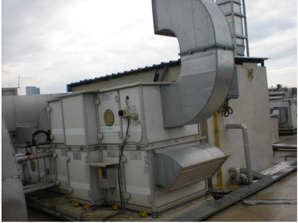
Şekil 3.25. İdari bina ofislerine ait klima santrali.
