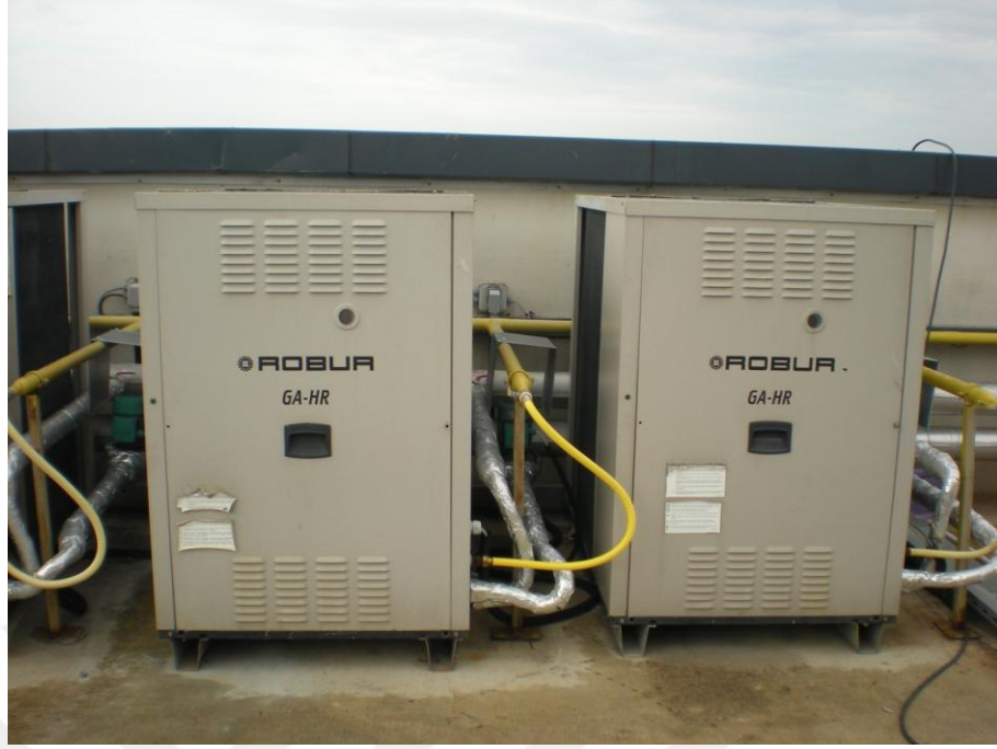
Şekil 3.31. Isı geri kazanım soğutma ünitesi cihazları.
