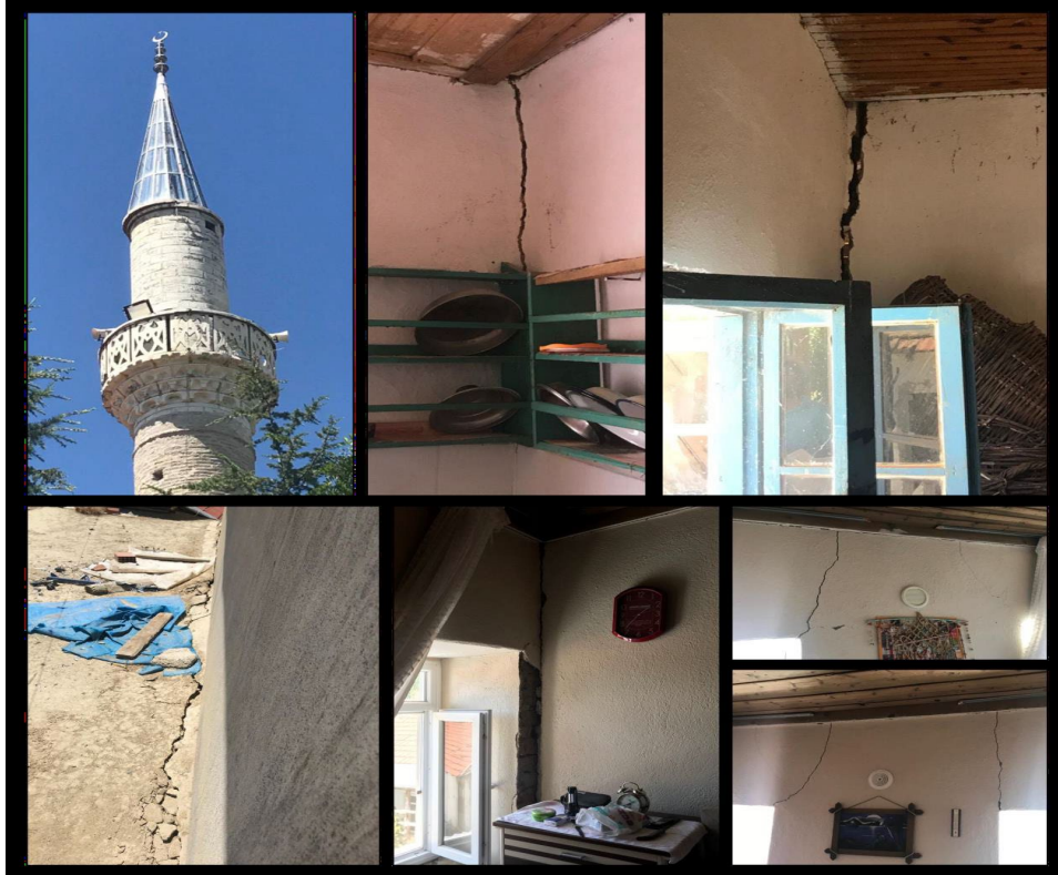
Şekil 3.7 08.08.2019 (TSİ), Bozkurt (Denizli) Mw 6.0 depreminin etkileri (Sözbilir vd. 2019).
