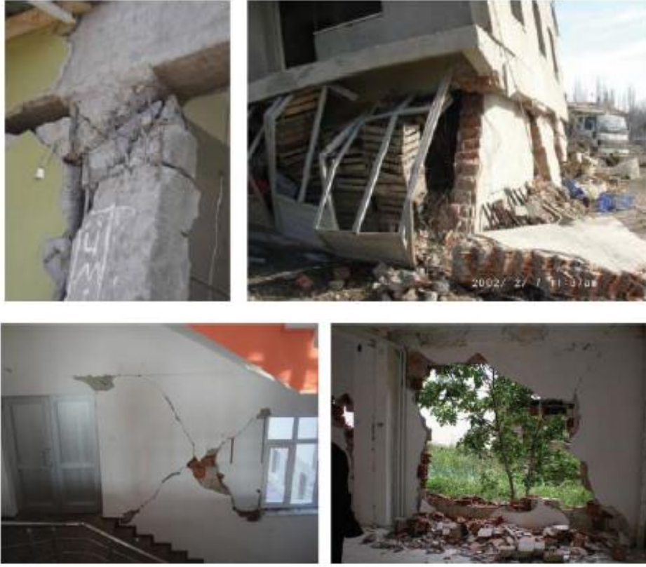
Şekil 2. Yapısal (üstte) ve yapısal olmayan (altta) hasarlara örnekler (TMMOB İnşaat Mühendisleri Odası, 2016)
