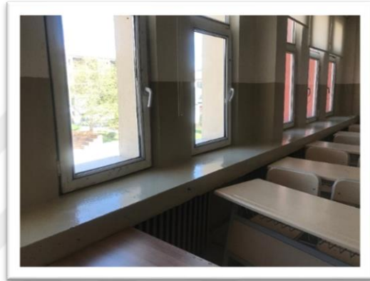
Şekil 4.88. Tokat 15 Temmuz Şehitler Anadolu Lisesi pencere durumu
