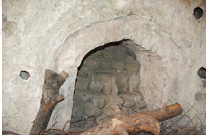
Fotoğraf 229: Poyracık Yıldırım Hamamı, güneyde kapatılan giriş
