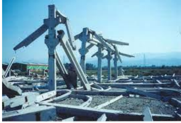
Şekil 1.10. Depremde hasar görmüş sanayi yapısı (Başkan, 2009)
