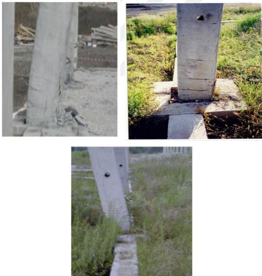
Şekil 3.1. Kolon-temel birleşiminde dolgu beton ezilmesi (Karahan, 2008; Özden ve ark., 2012; Yüksel, 2016)
