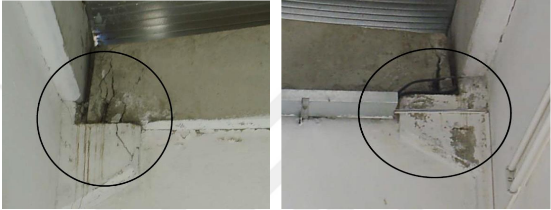
Şekil 1.13. Kiriş mesnetinde hasar oluşumu (Türkmen ve ark.)
