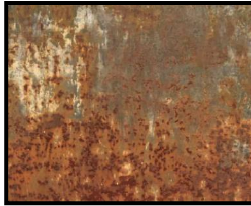
Şekil 3.5. Korozi aşınma görseli [170].
