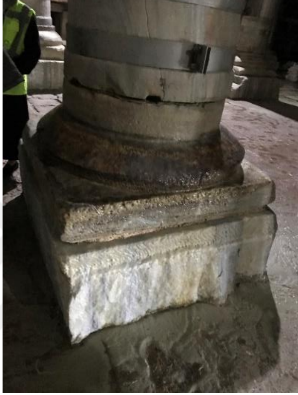
řekil 4. 77. Malzeme kaybı olan kaide detayı
