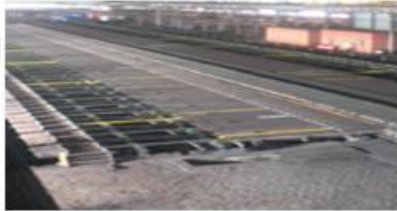
Şekil 2.6. Kontinü haddehane tesisi soğutma ızgaraları.
