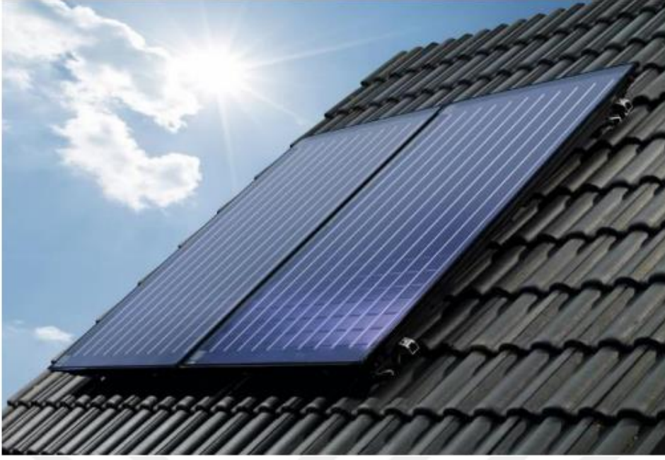
Şekil 15. Yapıda Güneş Kolektörlerinin Uygulanışı (URL7)
