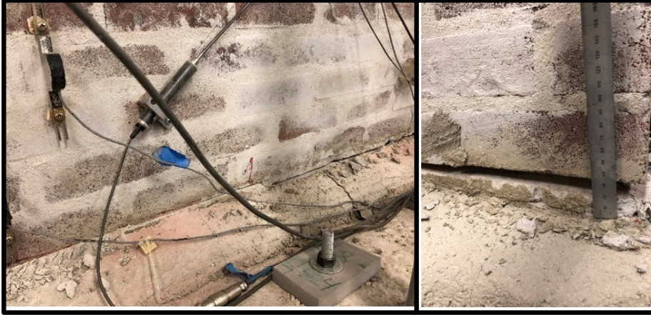
Şekil 3.31 : Duvar TD06'nın hasar tipi.
