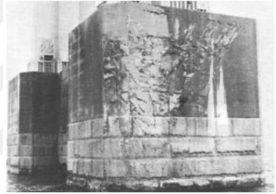
Şekil 2.24: Newport Köprü kazası, köprü hasarı.
