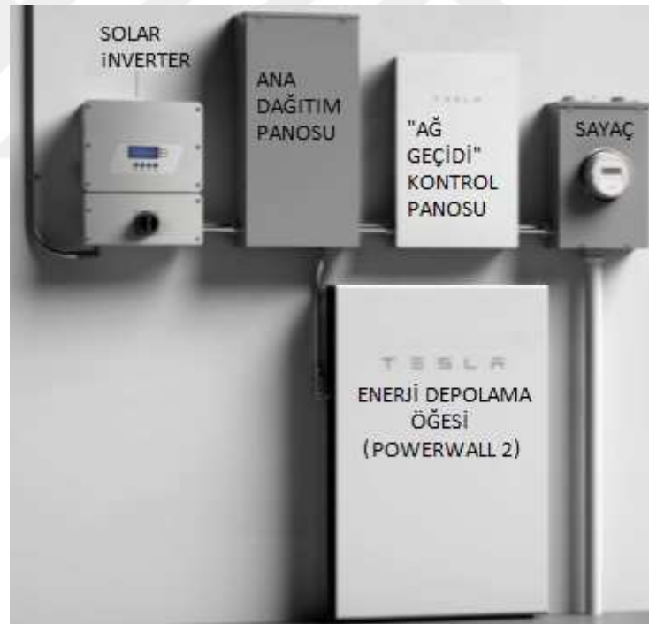
Şekil 3.7. Tesla Powerwall 2 ve diğer sistem bileşenleri
