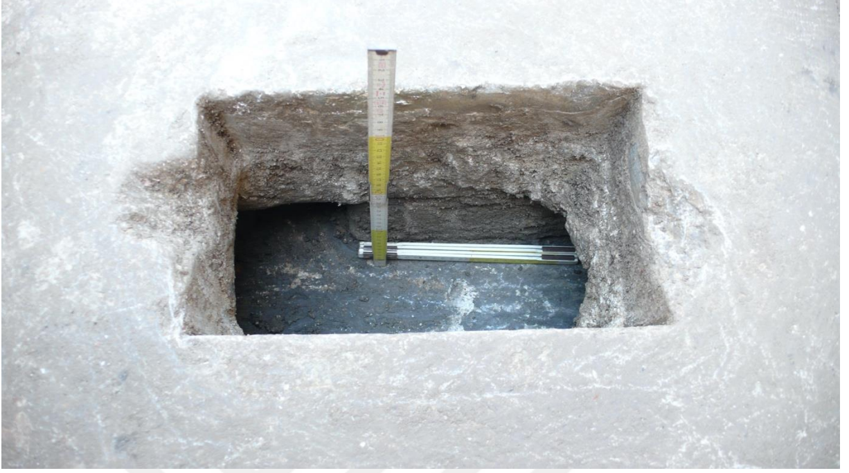
Su kanalında kireç birikimi
