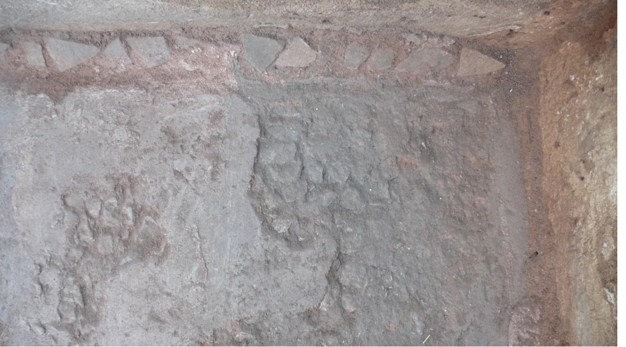
Havuz kenarları ve duvarlardaki sıva
