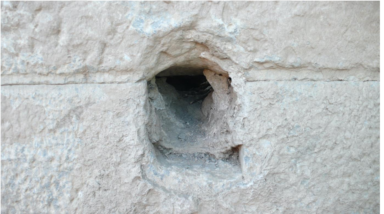
Tahliye kanalı içindeki kireç katmanları
