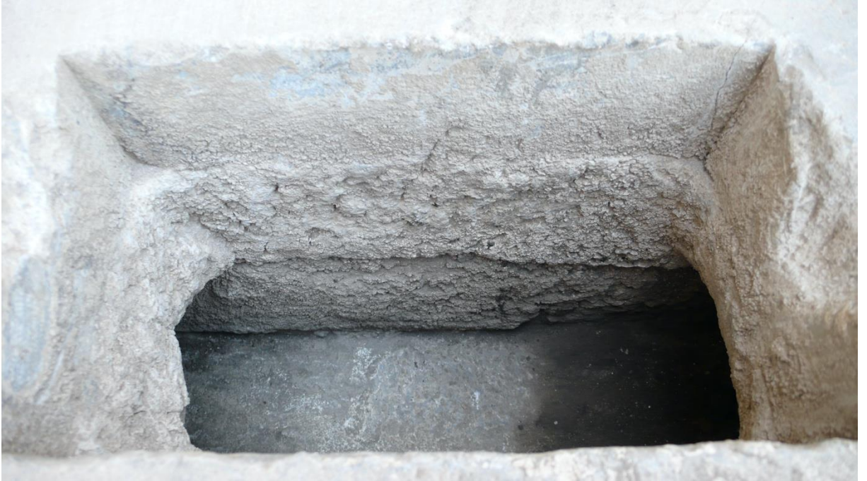
Müdahale ağızları iç kısımlarındaki kireç katmanları
