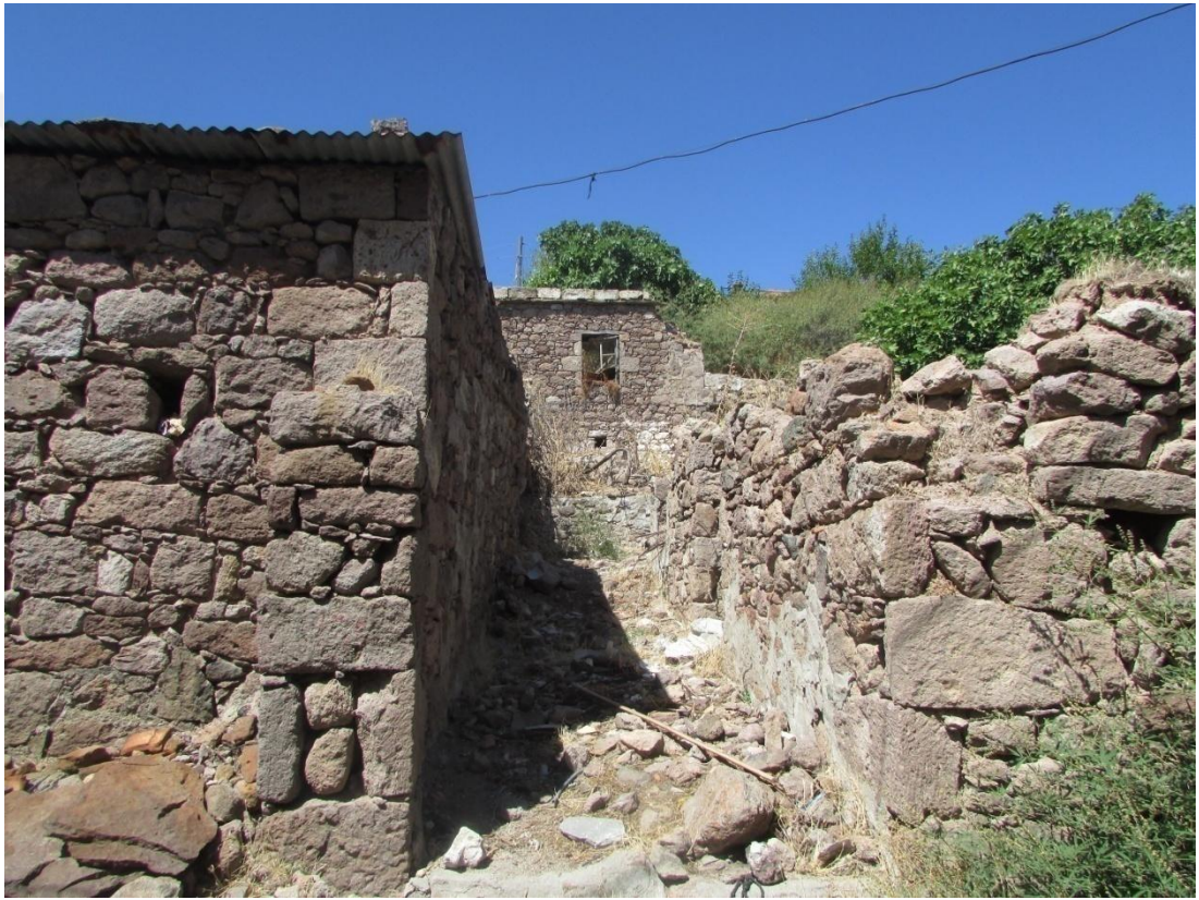
Şekil 5.2: Harap Durumdaki Geleneksel Yapılar (Çeliker, 2019)
