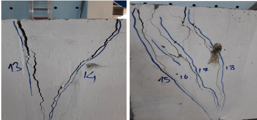
Şekil 3.9. Mesnet bölgesi kesme çatlakları
