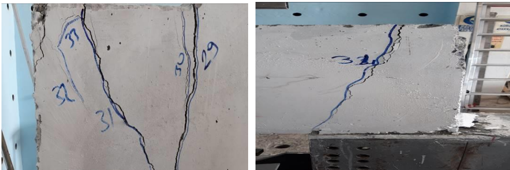
Şekil 3.75. Mesnet bölgesi kesme çatlakları
