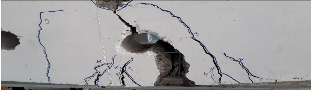
Şekil 3.39. K-2 numunesinin deney sonrası eğilme çatlak detayları
