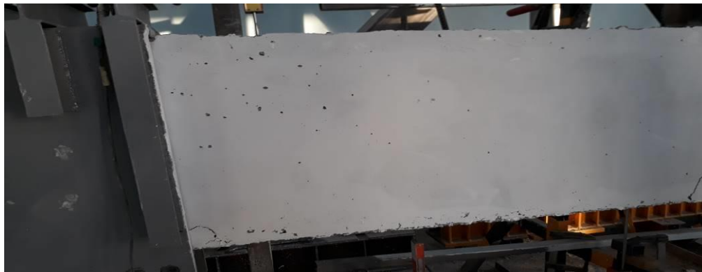
Şekil 3.86. Mesnet bölgesi ezilme ve çatlakların görünümü
