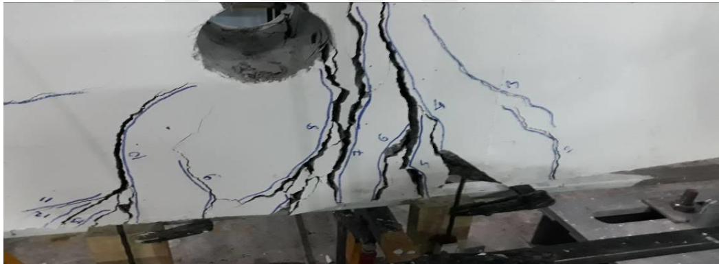
Şekil 3.28. K-1 numunesinin deney sonrası eğilme çatlak detayları
