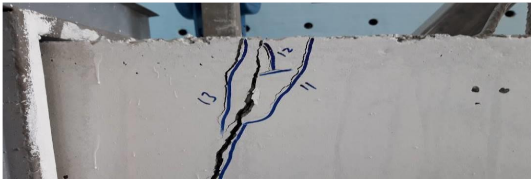
Şekil 3.42. Mesnet bölgesi kesme çatlakları
