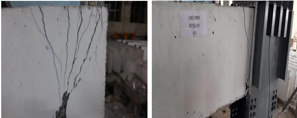
Şekil 3.53. Mesnet bölgesi kesme çatlakları
