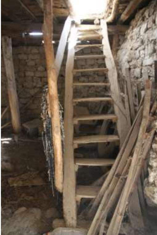
Resim 5.7. Rıht tahtaları çakılmamış merdiven (Bkz. Katalog 12)
