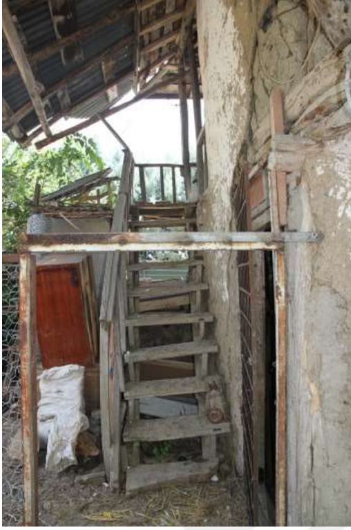
Resim 5.5. Rıht tahtaları çakılmamış merdiven (Bkz. Katalog 5)
